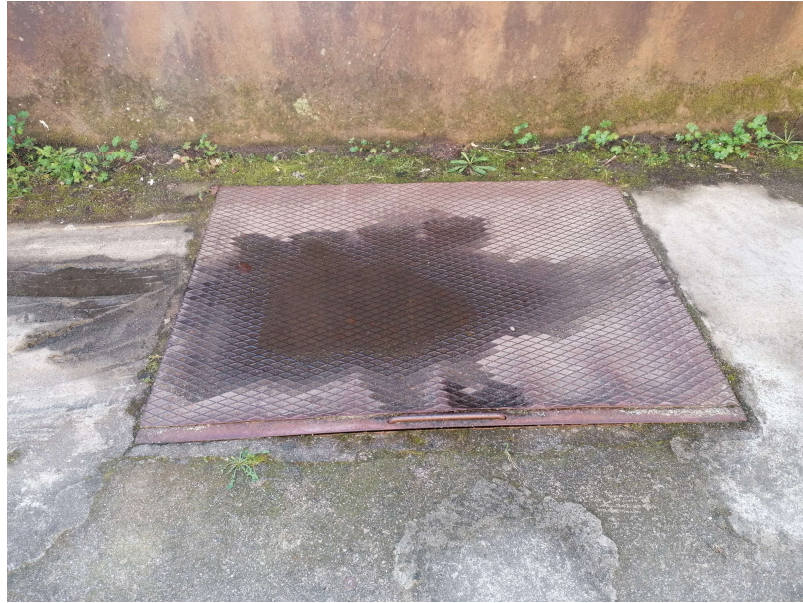
Sistema de bombeo de aguas negras y pluviales.
