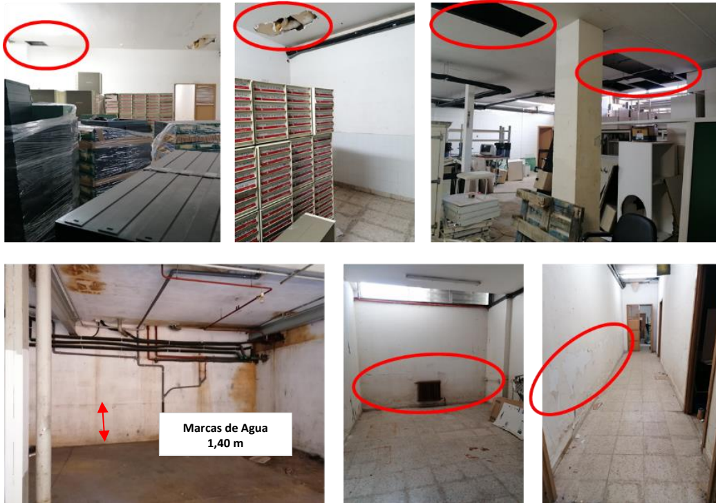
Figura 31. Desperfectos encontrados en la planta semisótano
