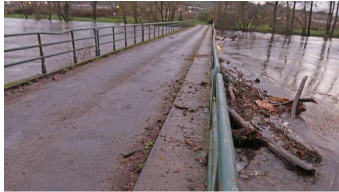
Figura 13. Nivel del río Avia a su paso por el puente A Quinza, en Ribadavia, 8 enero 2016 12
