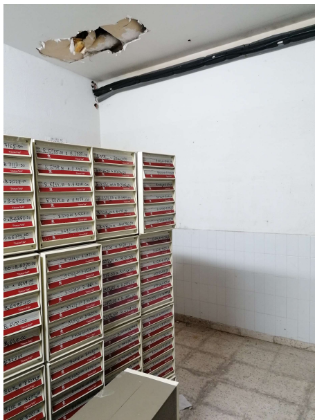
Detalle de oquedades en el techo de la planta semisótano
