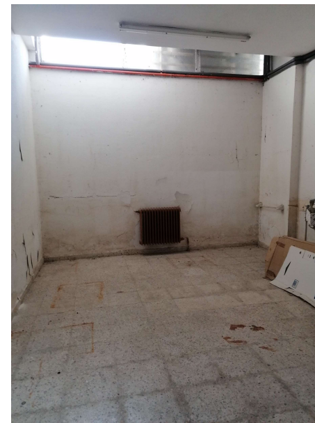
Humedades y pintura levantada en la planta semisótano.
