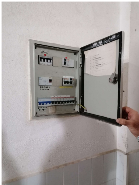
Cuadro eléctrico en la planta semisótano
