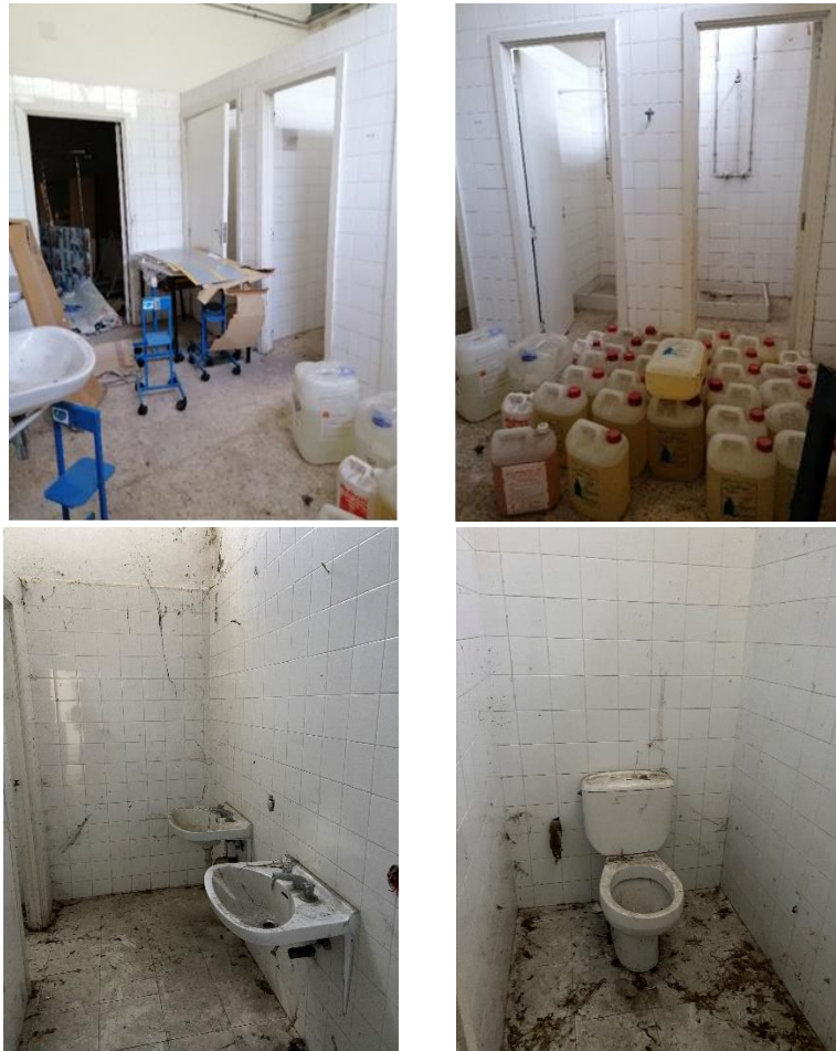
Figura 30. Puntos de entrada de agua por el sistema de saneamiento del centro de salud
