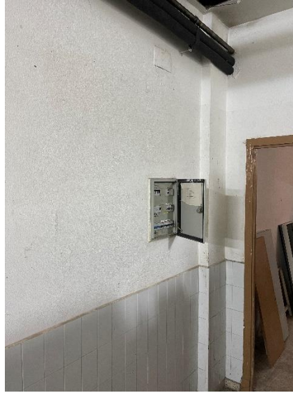
Figura 36. cuadro eléctrico ubicado en la planta semisótano.
