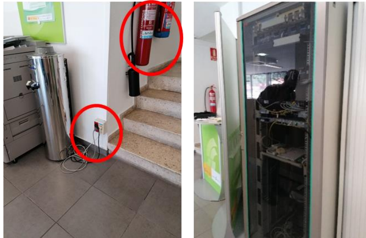
Figura 38. Enchufes, extintores y rack eléctrico ubicados en la estancia central de la planta baja
