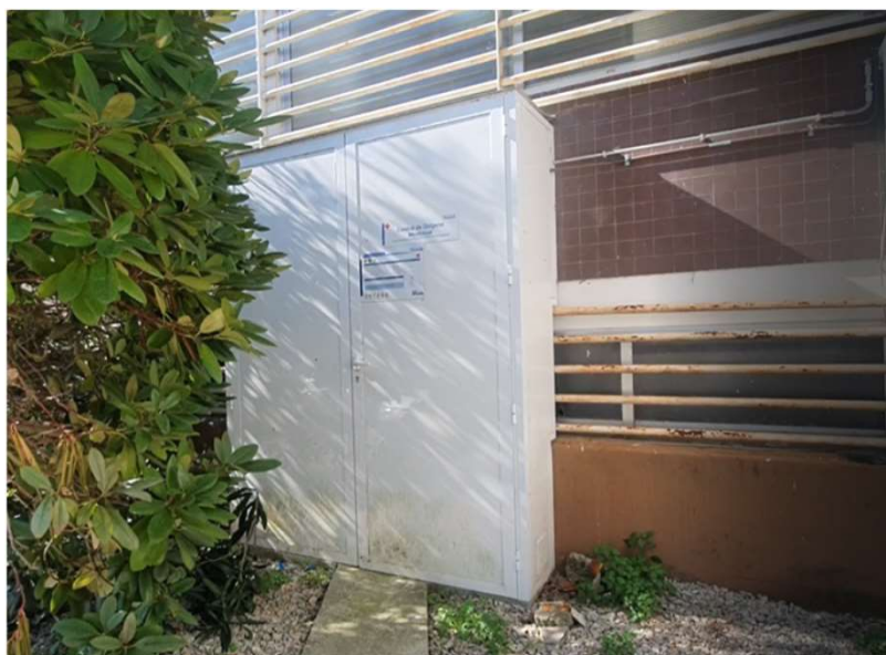
Central de oxígeno medicinal ubicada a la izquierda del acceso al servicio de urgencias.
