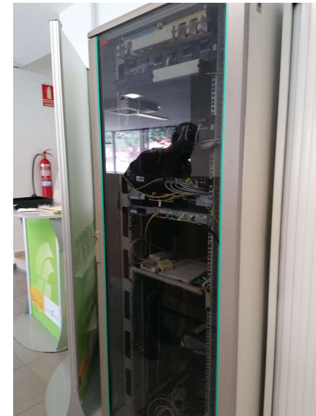
Rack eléctrico en la sala principal de la Tesorería General de la Seguridad Social.
