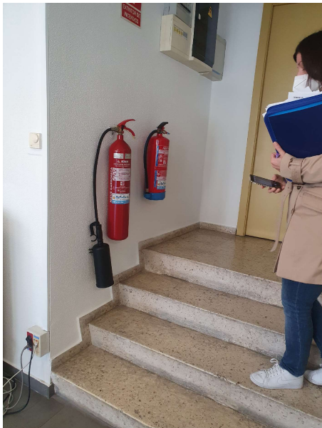
Extintores y cuadro eléctrico Tesorería General de la Seguridad Social.
