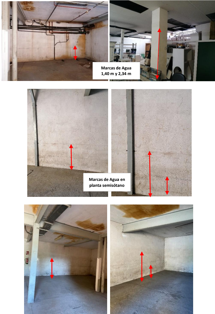
Figura 28. Marcas de agua en interior de la planta semisótano.
