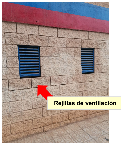
Calle Colombia. Rejillas de ventilación de dimensiones ancho 42 cm y alto 65 cm, con una altura respecto de la acera de 1,15 m la primera de ellas y 1,12 m la segunda.
