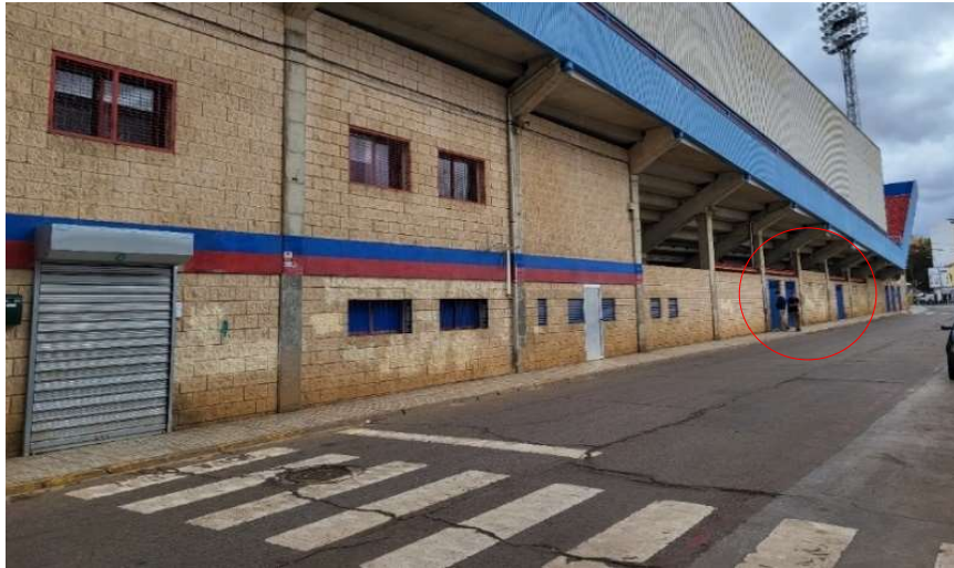
Fachada calle Colombia. Tres accesos (puertas 6, 5 y 4, puertas: Hernán Cortes, Prensa, y Tribuna lateral derecha), de 2,03 m de ancho, sin presentar sistema de protección frente inundaciones instalado.
