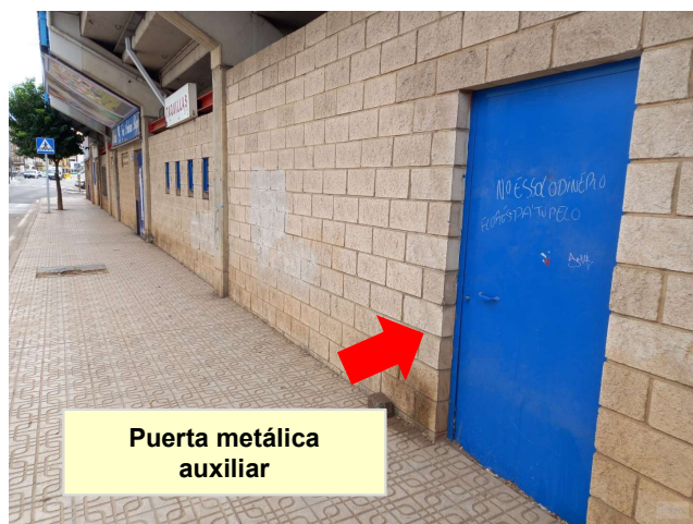
Puerta metálica auxiliar (no para el público general) de 1,02 m de ancho por 2,1 m de alto, situada a ras de pavimento, sin sistema anti-inundaciones instalado.
