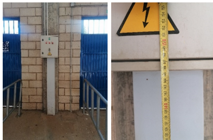
Figura 99. Cuadro eléctrico de maquinaria
