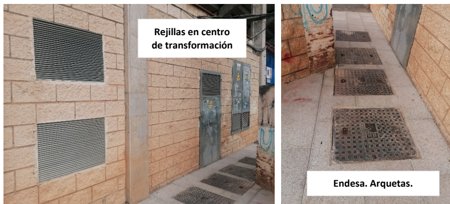
Figura 51. Inmediaciones del centro de transformación
