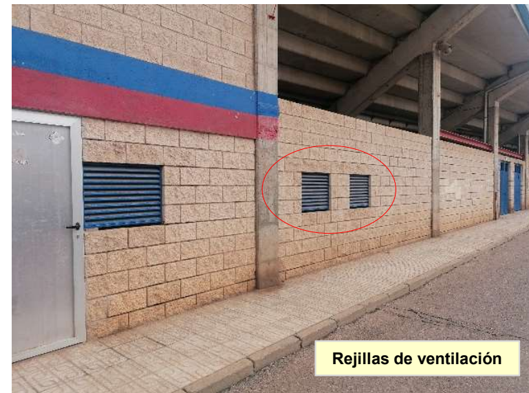
Fachada calle Colombia. 2 Rejillas de ventilación de 82 cm de ancho y altura 62 cm. Cota desde acerado de 1 m.
