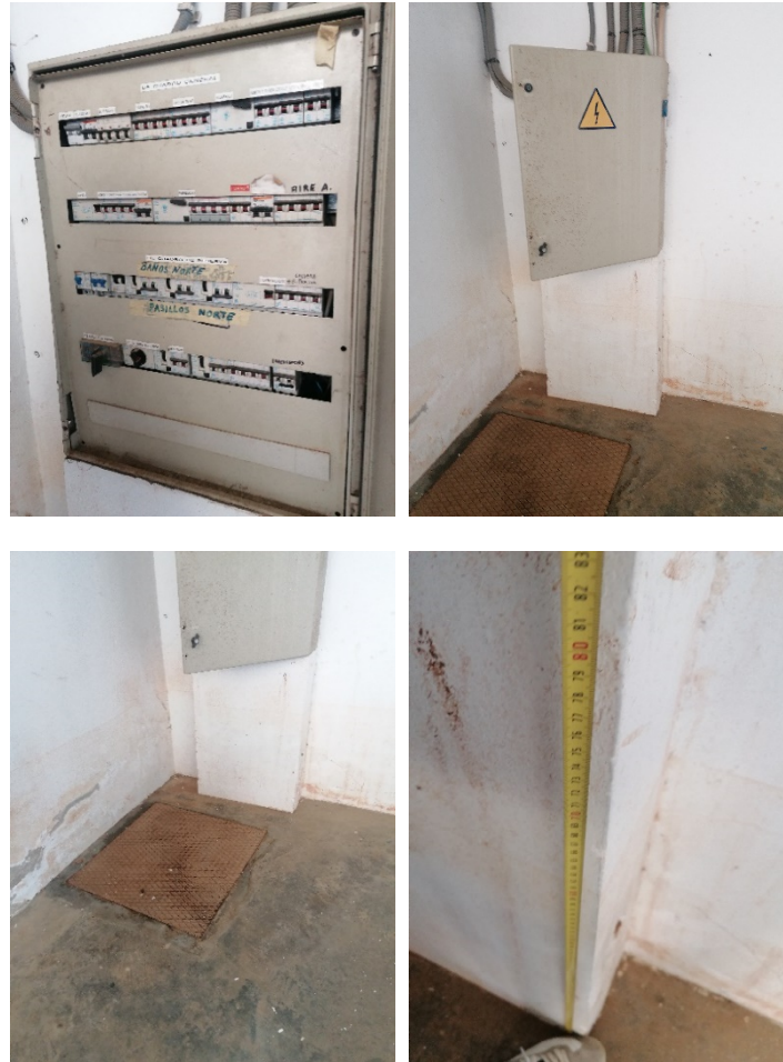
Figura 98. Cuadro eléctrico general
