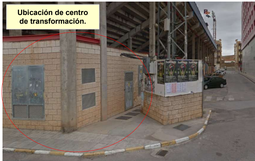
Centro de transformación ubicado en la esquina de la calle Colombia y la calle posterior al Hotel Acosta Centro.
