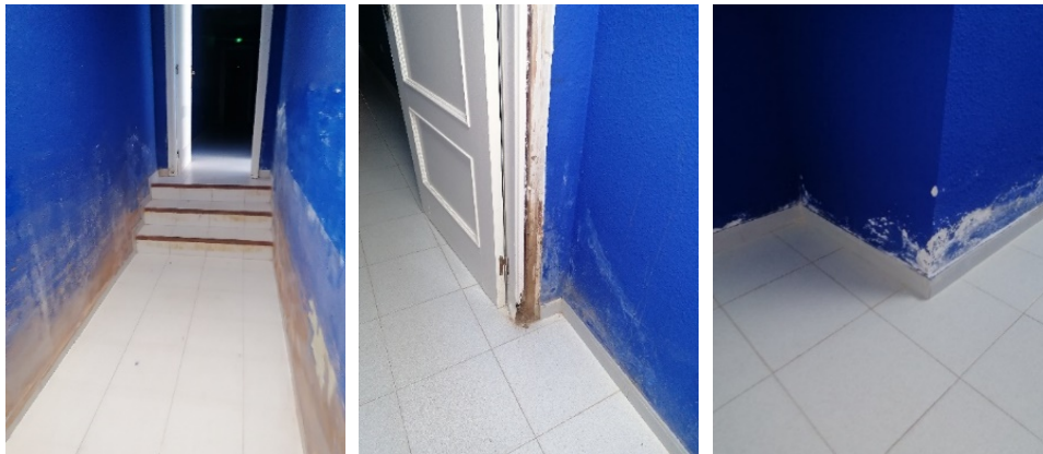
Figura 93. Daños en pasillo interior
