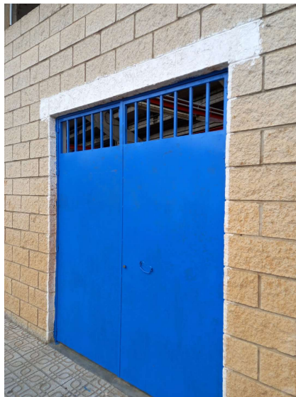
Fachada calle Fray Alonso Cabezas. Puerta 8 con dimensiones de 2,03 m de ancho por 2,20 m de alto, sin sistemas anti-inundaciones instalados.
