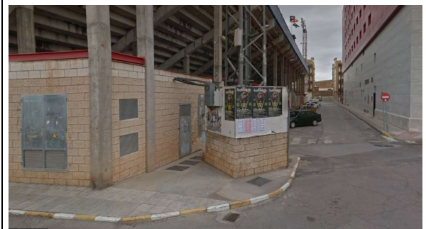
Centro de transformación esquina calle Colombia con la calle posterior al Hotel Acosta Centro.
