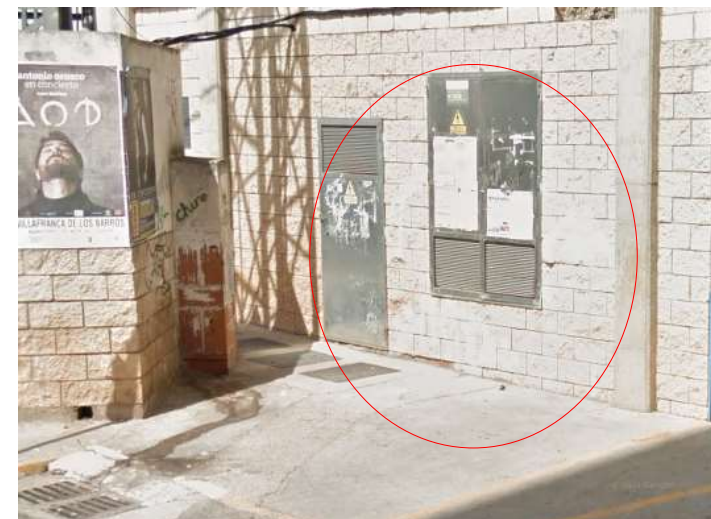
armario de instalaciones de anchura 1,05 m por 2,17 de alto, seguido de un segundo armario de ancho 1,55 m, que presenta dos rejillas de ventilación en su parte inferior, con una distancia al acerado de 54 cm. Estos dos armarios forman parte centro de transformación.
