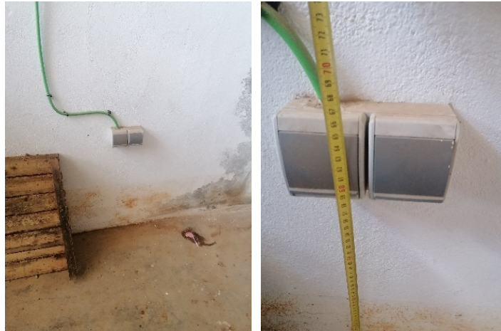
Figura 100. Tomas e interruptores de electricidad elevados
