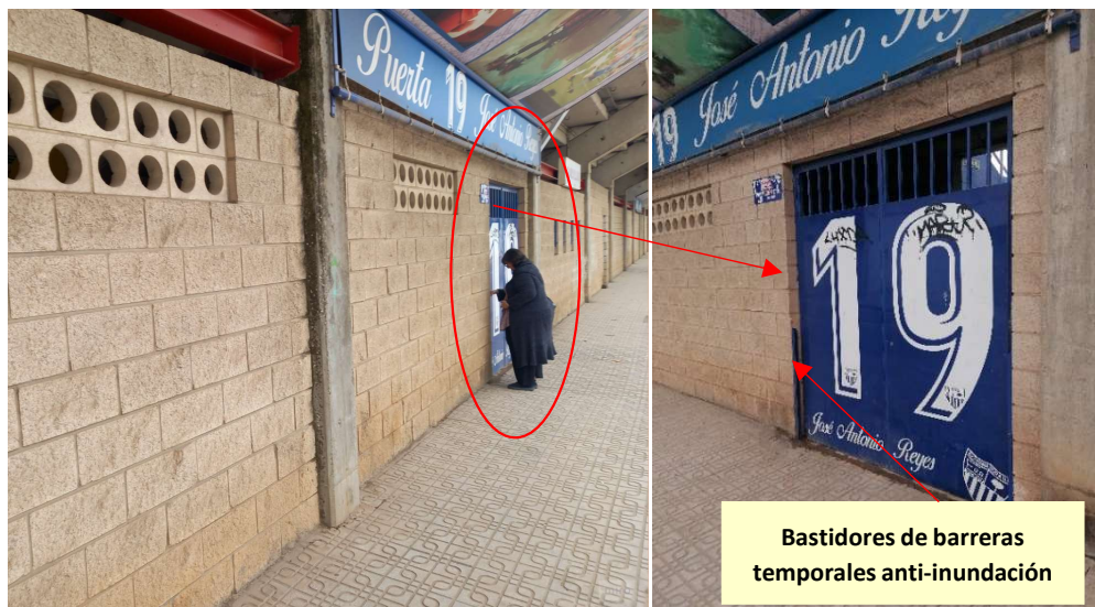
Fachada calle Badajoz. Dos ventanas altas con aberturas redondas situadas a 1,8 m del suelo y puerta 19, de 2,03 m de ancho por 2,20 m de alto con sistemas anti-inundaciones instalados. Se desconoce si el sistema está homologado.
