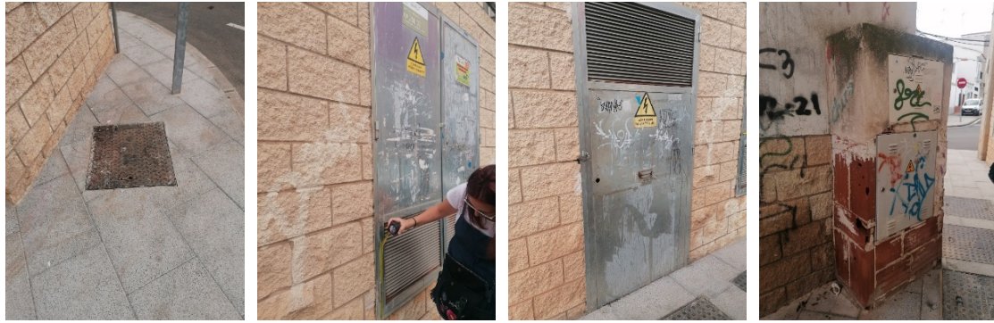
Figura 52. Detalles de los Armarios de instalaciones eléctricas y arquetas ubicadas en la esquina sureste de la calle posterior al Hotel Acosta
