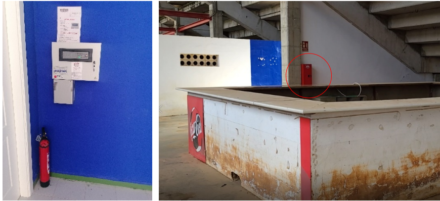
Figura 108. Extintores ubicados en los corredores de la instalación.
