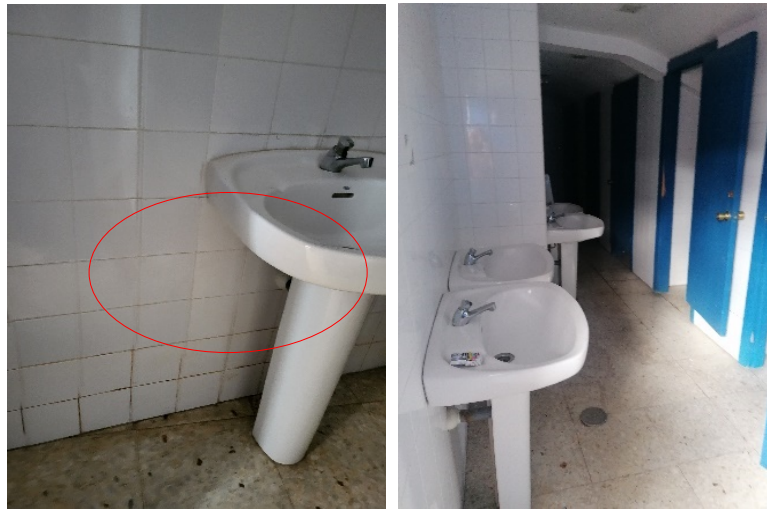
Figura 97. Marca de la inundación en aseos(II).
