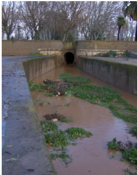
Figura 6. Arroyo Charnecal en el parque de las Mercedes, donde entra a formar parte del colector de residuales. Fuente: Iramirezmanchon
