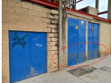
Figura 92. Centro de transformación
