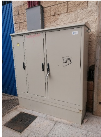
Figura 119. Armario de instalaciones a proteger.
