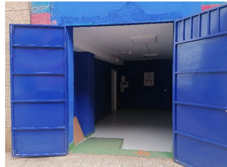
Fachada calle Colombia. Acceso principal de la zona de oficinas ( dimensiones ancho de 1,92 m y una altura de 2,40 m). Dicha puerta no presenta sistemas de protección frente a las inundaciones instalado.
