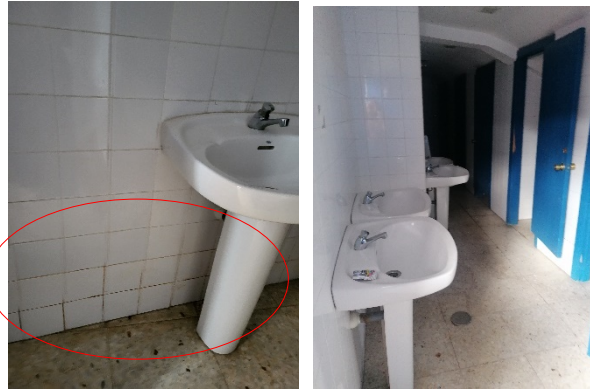
Figura 103. Marca de la inundación en aseos
