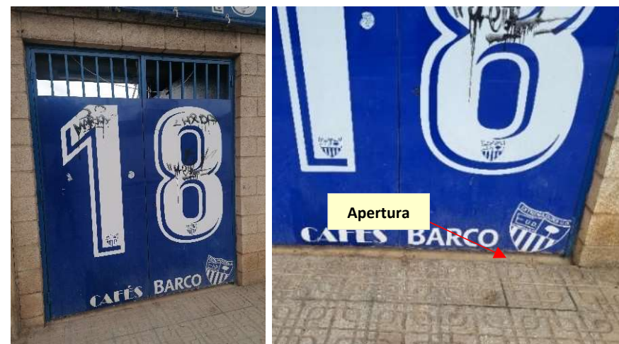
Fachada calle Badajoz. Puerta 18, con dimensiones de 2,03 m de ancho por 2,20 m de alto, sin sistemas anti-inundaciones instalados. Cabe mencionar que en la puerta 18, figura una apertura en su zona inferior de unos 8 cm.
