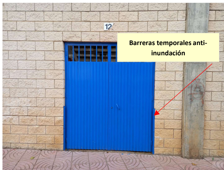
Fachada calle Fray Alonso Cabezas. Puerta 12 con dimensiones de 2 m de ancho por 2,20 m de alto, con sistemas anti-inundaciones no homologados instalados hasta 1 m.
