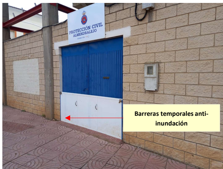
Fachada calle Fray Alonso Cabezas. Puerta "Protección Civil Almendralejo" con dimensiones de 2,62 m de ancho por 2,20m de alto, con sistema anti-inundaciones instalado hasta 1 m de altura, incluida barrera de protección .
