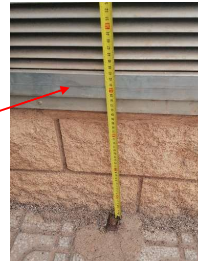
Esquina calle Colombia con la calle posterior al Hotel Acosta Centro. El armario de instalaciones cuenta con dos rejillas de ventilación en su parte baja que presentan una distancia con el acerado de aproximadamente 35 cm.
