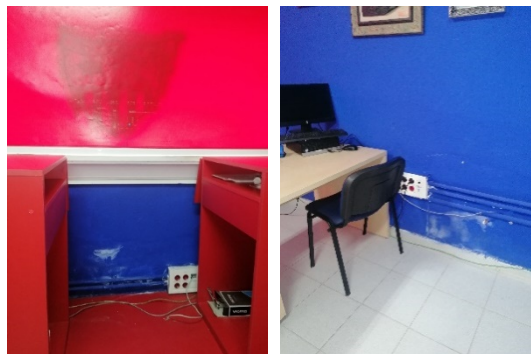
Figura 101. Cuadro eléctrico y tomas en oficinas
