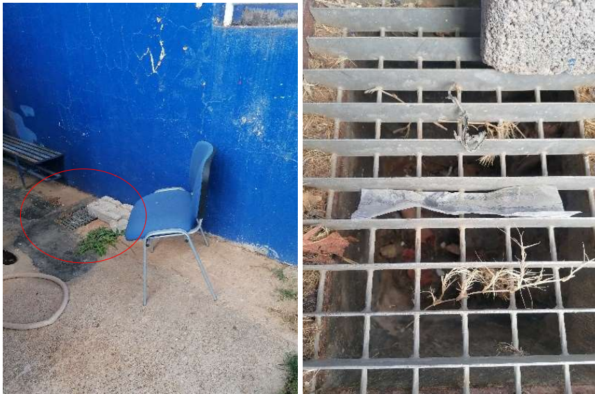
Arqueta que recoge el agua excedente del terreno de juego.
