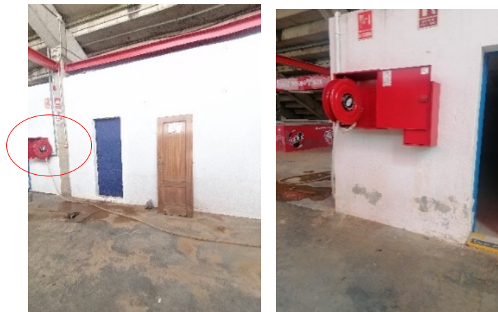
Figura 107. BIEs ubicadas en el perímetro de la instalación
