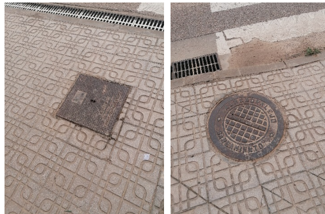
Figura 64. Inmediaciones de la Puerta 16. Acometidas.
