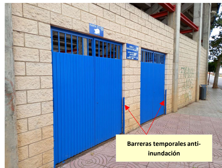
Fachada calle Fray Alonso Cabezas. Puertas 11,1 y 11,2 con dimensiones de 2 m de ancho por 2,20 m de alto, con sistemas anti-inundaciones instalados hasta 1 m.
