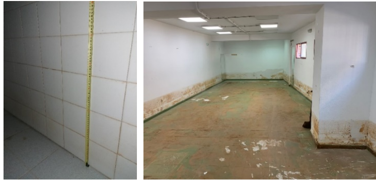
Figura 94. Desperfectos tras las inundaciones, pasillo, oficinas y aseos
