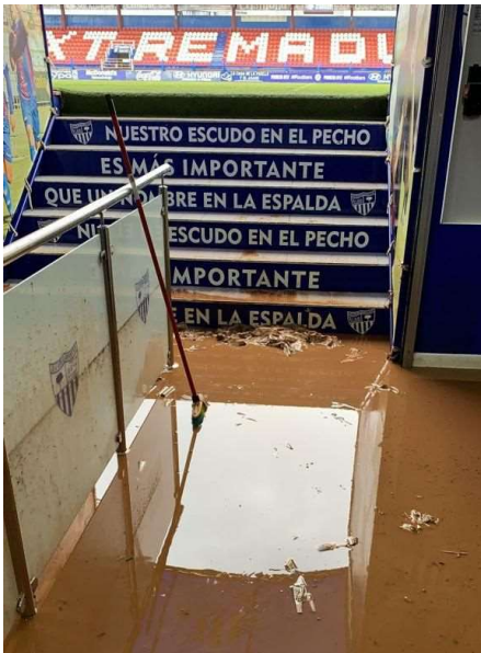
Acceso al terreno de juego. La cota del agua alcanza 15 cm aproximadamente. Marcas de agua de 60 cm en las escaleras aproximadamente.
