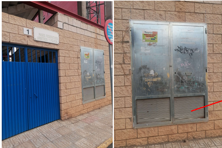
Esquina calle Colombia con la calle posterior al Hotel Acosta Centro. Armario de instalaciones de anchura 1,55 m, perteneciente a un centro de transformación ubicado en esta esquina.
