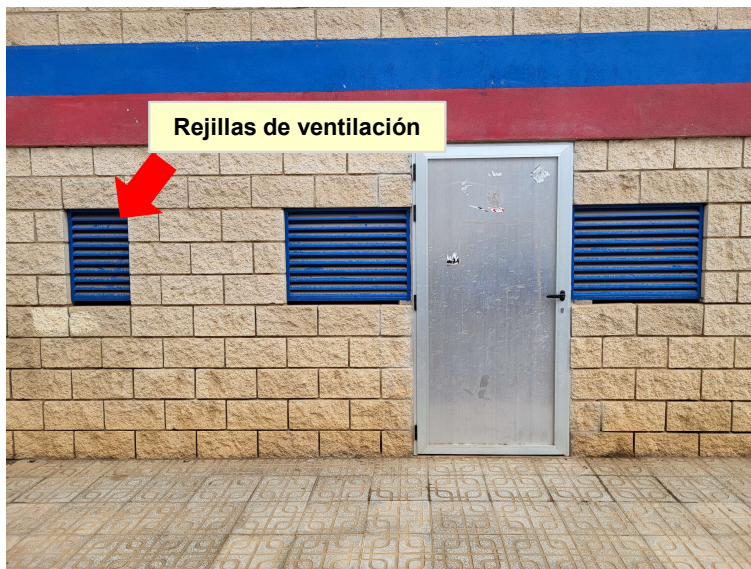
Calle Colombia. Rejilla de ventilación de dimensiones 42 x 62 cm y una puerta metálica de 1 hoja de 1 m de ancho, ubicada entre dos rejillas de ventilación de dimensiones 100 x 62 cm de ancho.
