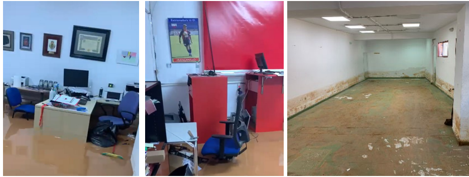
Figura 109. Desperfectos tras las inundaciones, almacén, sala de prensa y oficinas
