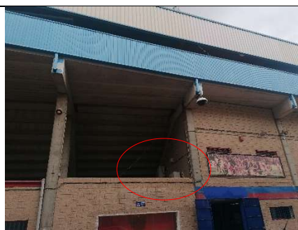
Unidad exterior de aire acondicionado elevada.
