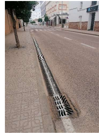
Inmediaciones de la puerta 16. Sistema de drenaje de la calle.
