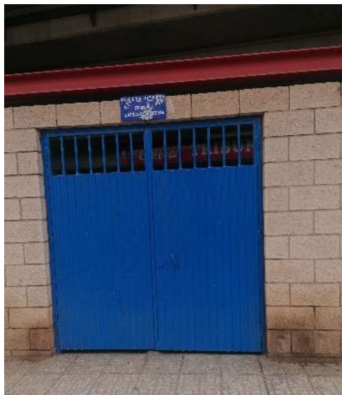
Calle Colombia. Puerta 4, de 2,03 m de ancho por 2,20 de alto. Esta puerta no presenta sistema anti-inundaciones instalado.
