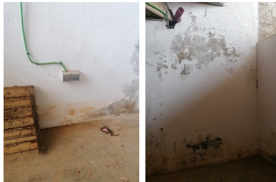
Figura 95. Desperfectos tras las inundaciones, corredores perimetrales
