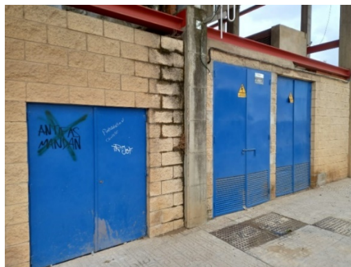
Figura 66. Centro de transformación y armario de instalaciones
