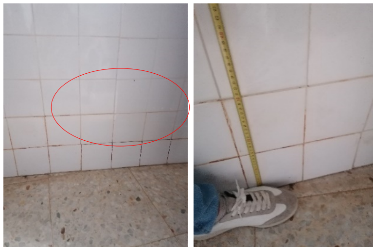
Figura 96. Marca de la inundación en aseos(I).
