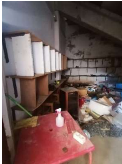
Almacenes situados en el interior del Estadio. La cota del agua alcanza 15 cm aproximadamente.
