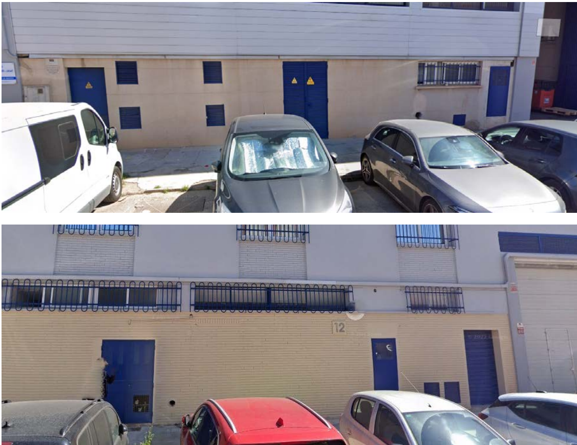
Ilustración 29. Centro de transformación e instalaciones en C/Pintor Joaquín Sorolla 12.
