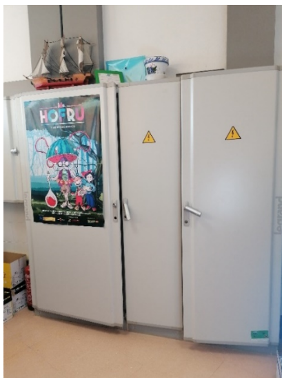
Figura 40. Cuadro eléctrico interior
