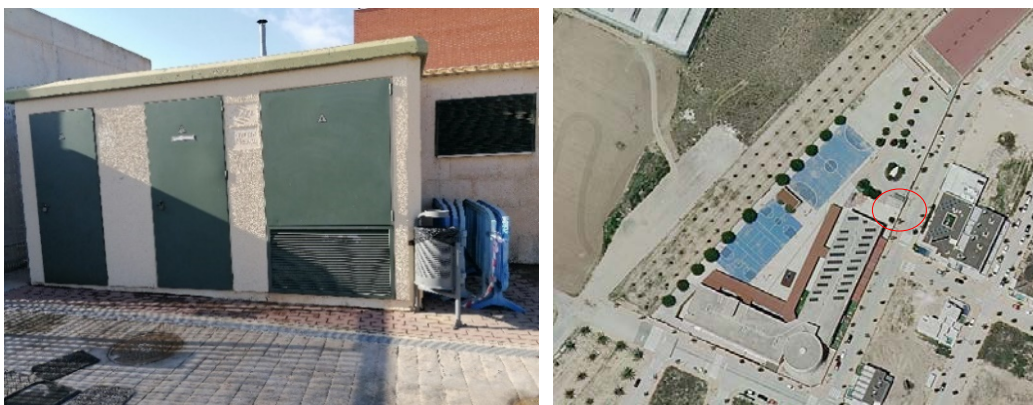
Figura 39. Centro de transformación
