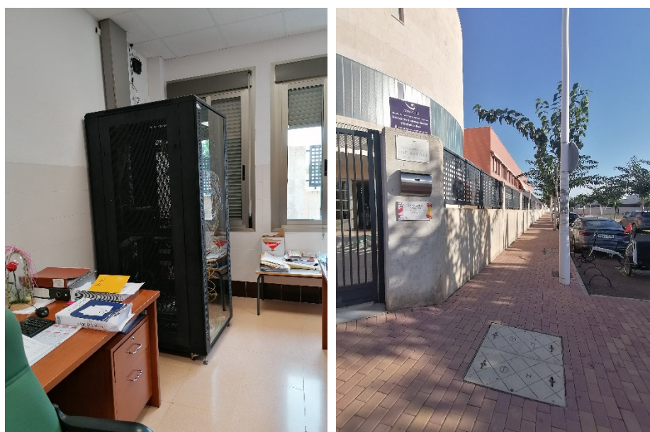
Figura 43. Sistema de comunicaciones rack en el interior del edificio y acometida exterior
