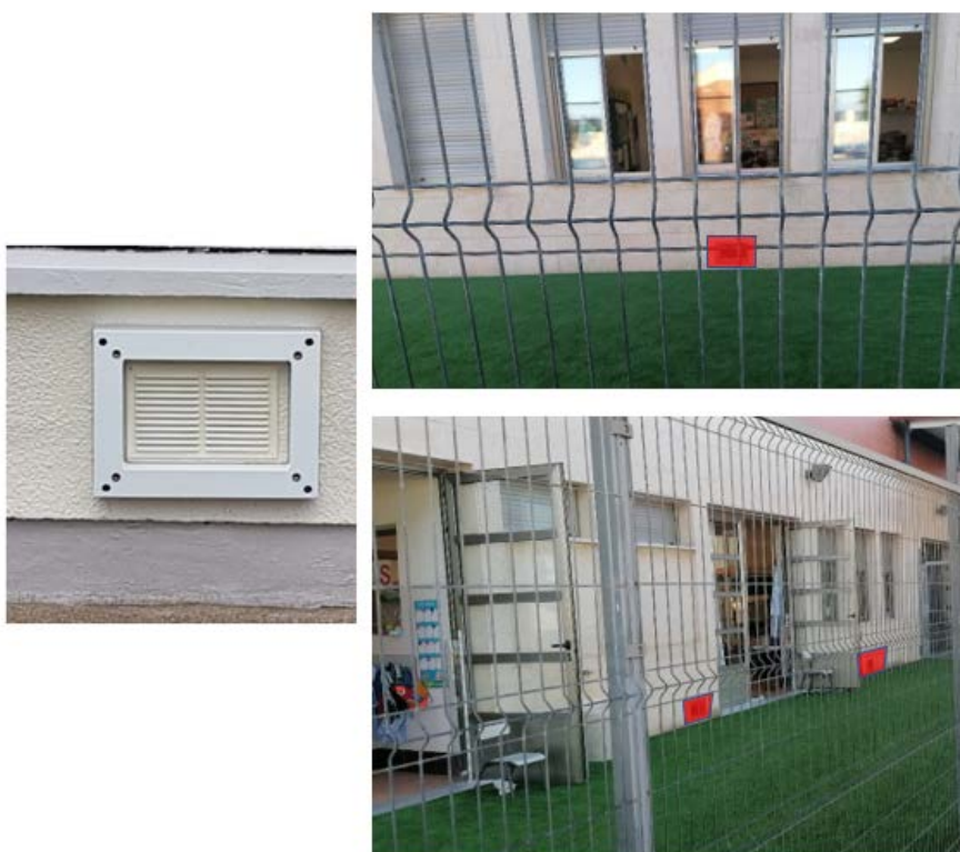
Figura 62. Cubierta protección ventilación (Fuente: LFS)
