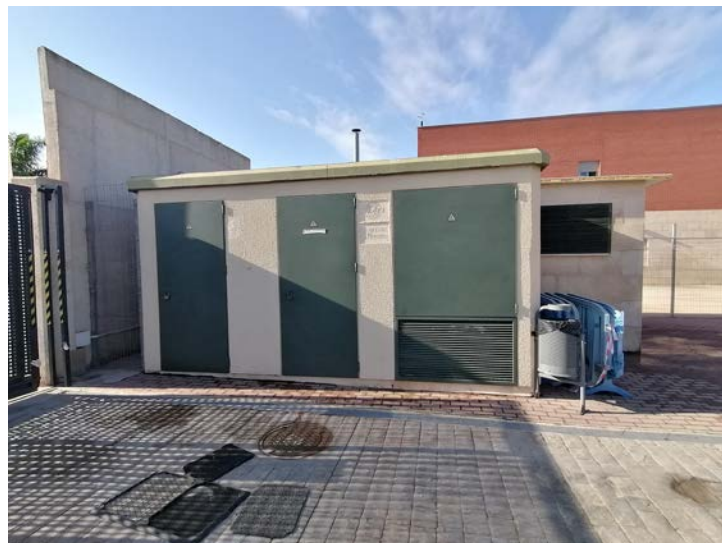
Centro de transformación
