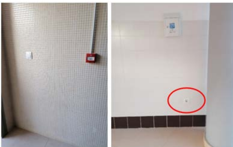
Figura 41. Interruptores y tomas de corriente elevadas
