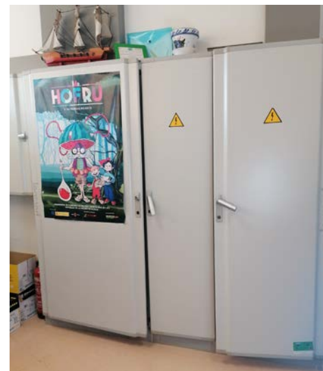
Cuadro eléctrico interior
