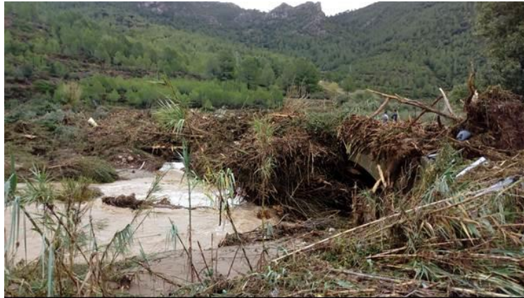
Fotografía 5. Puente de la carretera C240Z totalmente obturado. TM Vilaverd.
