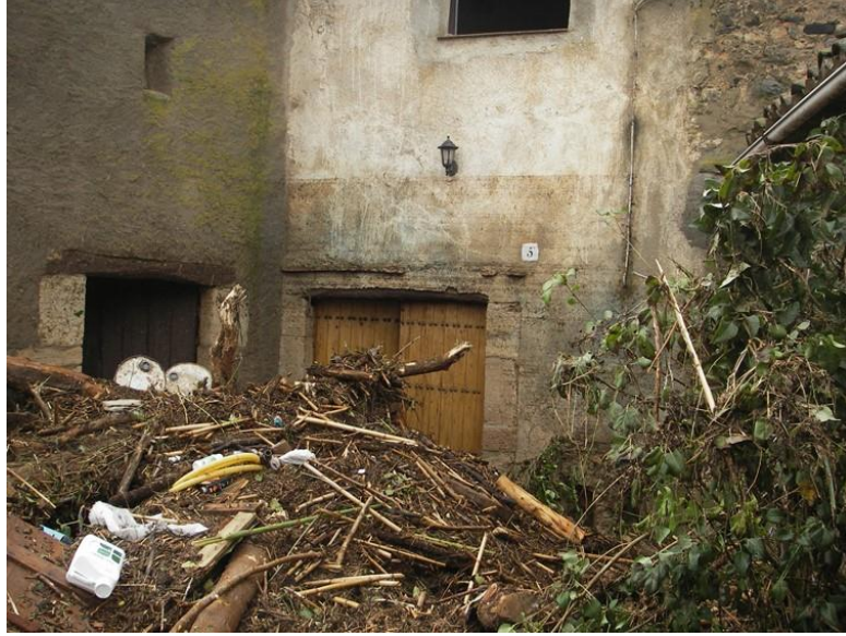
Fotografía 10 Río Milans, nivel alcanzado por el agua en el molino Guasch, aproximadamente unos 2 metros superior a la detectada en las inundaciones del año 1994. TM Espluga del Francolí
