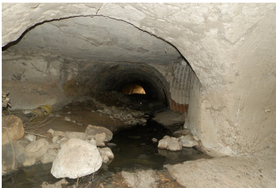
Figura 3: Cámara de reparto donde se unen el Ballesteros y el Calderón. Fuente: Ayuntamiento Algámitas
