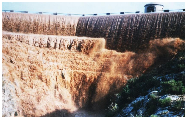
Figura 4 Desbordamiento de la presa de Almansa en noviembre de 1984.
