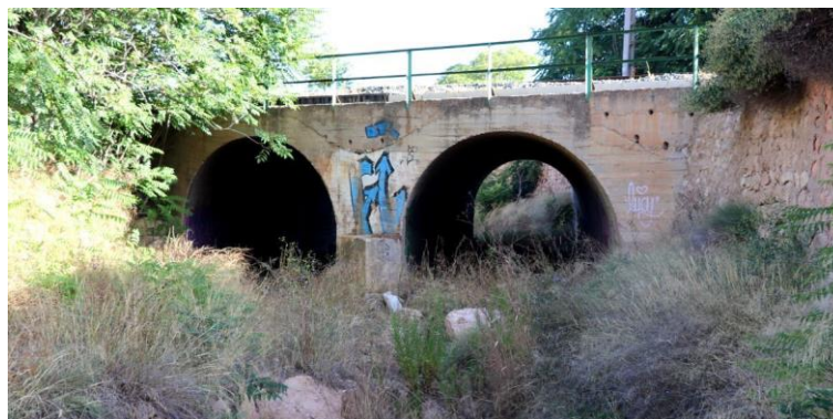
Figura 6. Vías de desagüe que quedaron taponadas en la tormenta de 1955.
