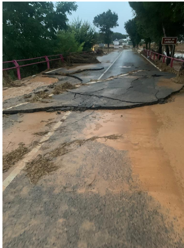
Figura 2 Destrozos en la carretera de Iniesta a Ledaña. Fuente: Voces de Cuenca.
