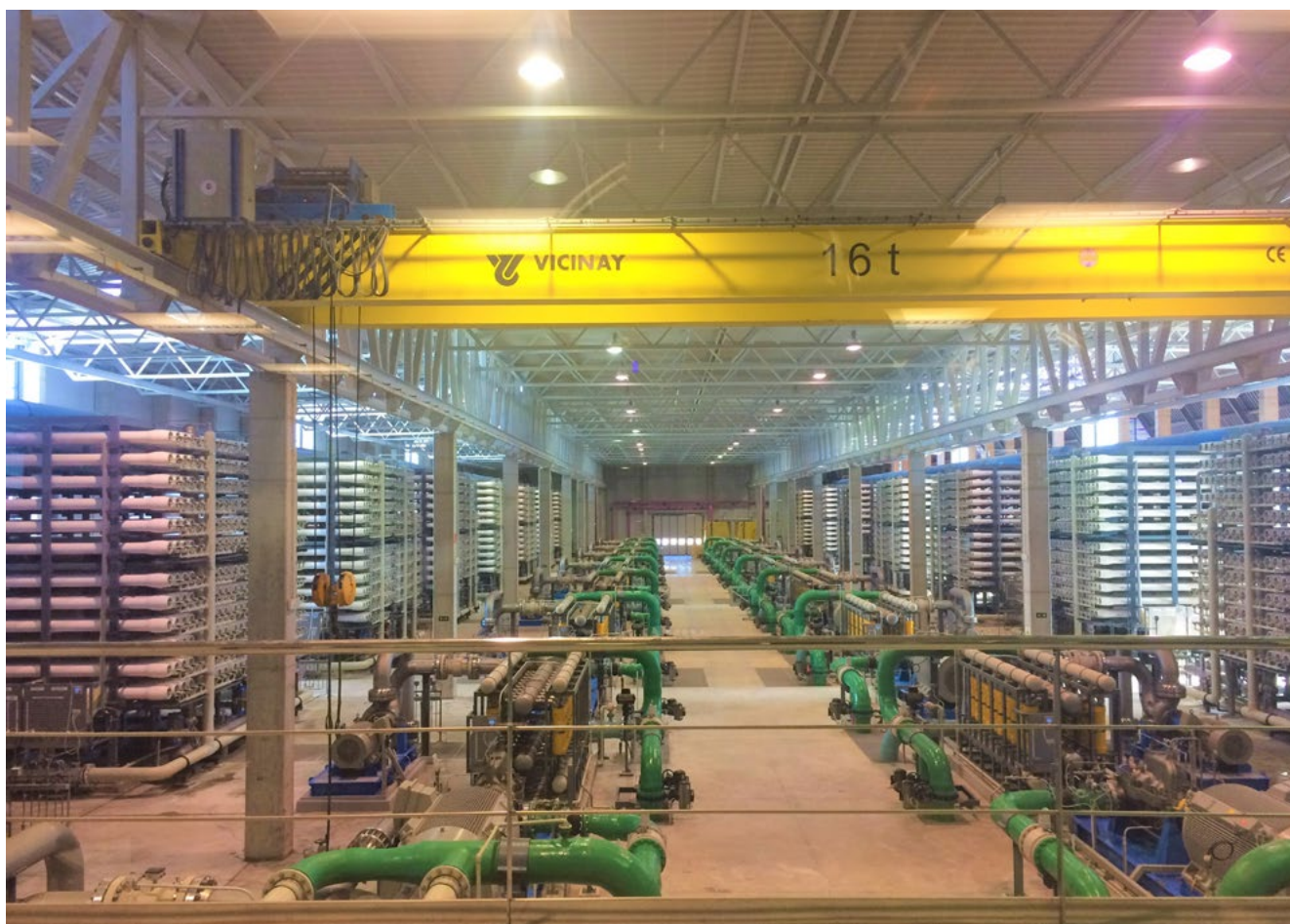
Interior de IDAM Torrevieja (Alicante)
