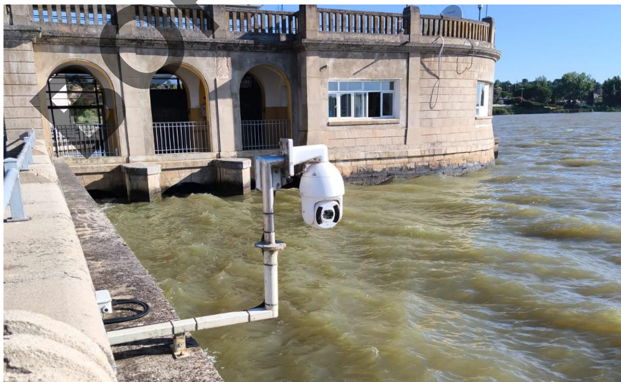
Imagen 60. Cámara Domo para la explotación de una presa controlando la apertura de compuertas
