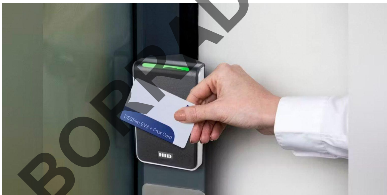
Imagen 57. Control de acceso a instalaciones por tarjeta identificativa
