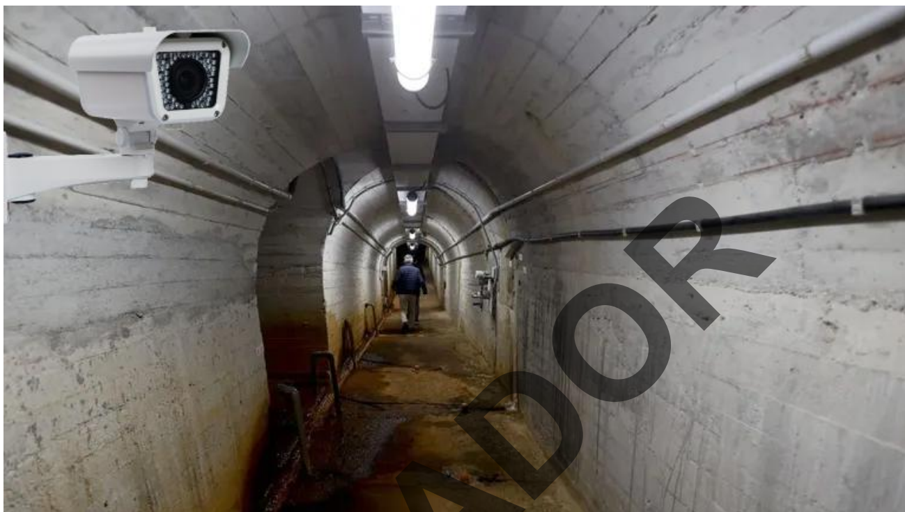
Imagen 66. Cámara de videovigilancia en el interior de la galería de una presa
