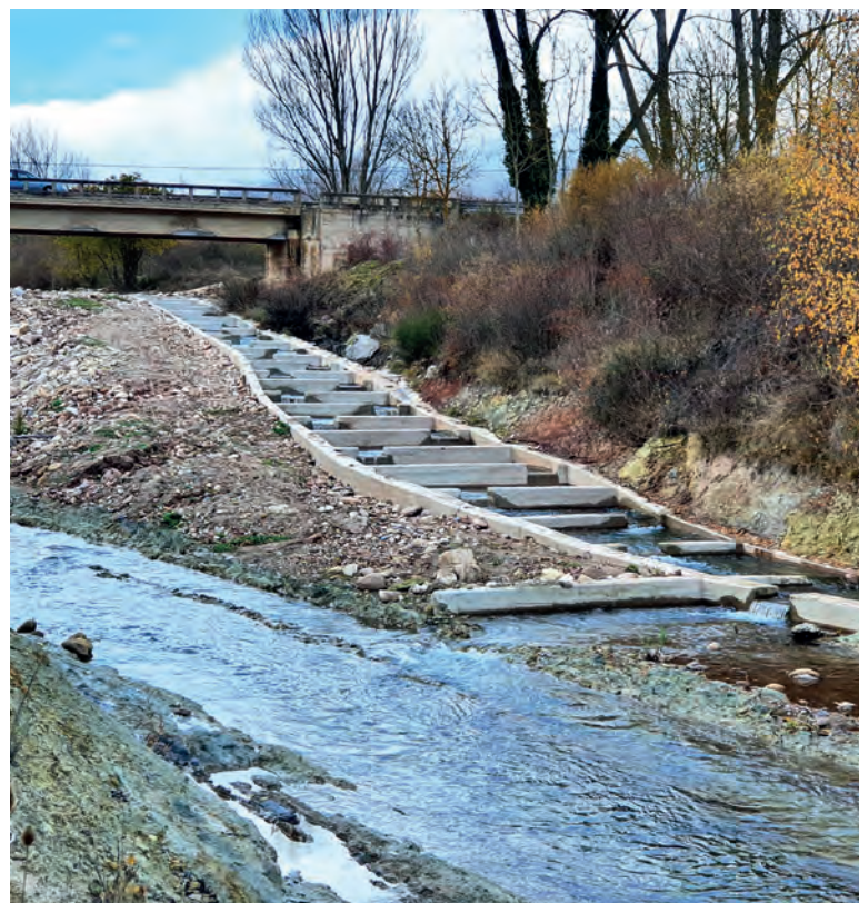
Escala de peces construida por la Confederación Hidrográfica del Ebro en el río Híjar (Cantabria)
