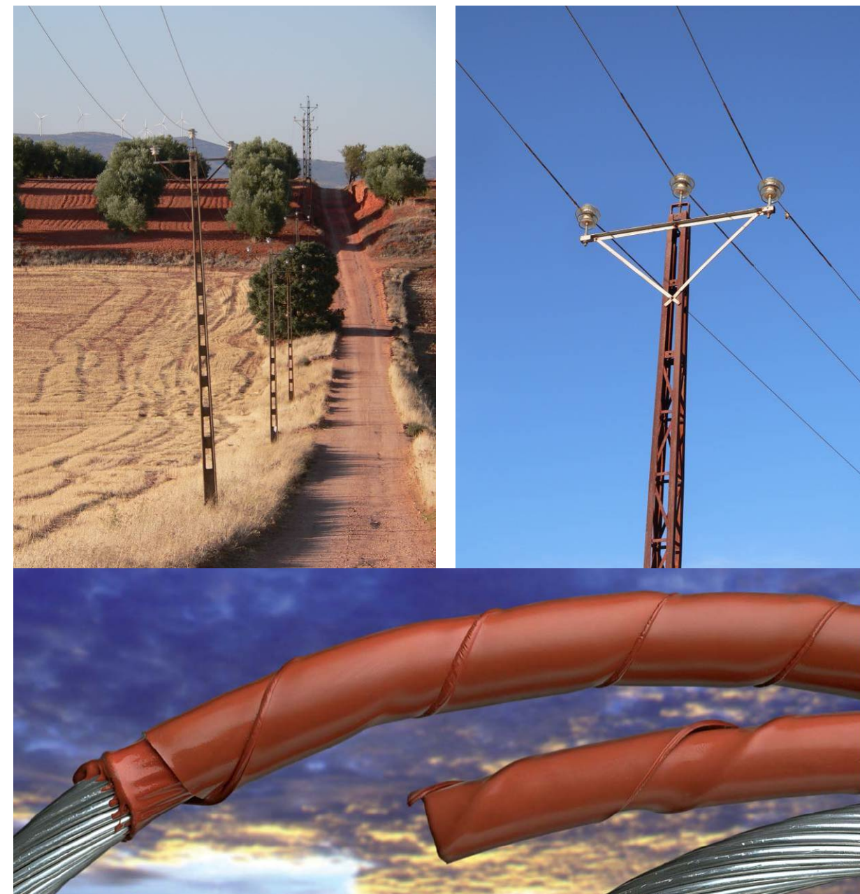
Figuras 1.10 a 1.12: aspecto de un tendido corregido (T.M. Valdepeñas, Ciudad Real), detalle del aislamiento efectuado en el marco del Plan de Actuaciones coordinado y detalle del aislamiento OLIT-M en rojo (tomado del catálogo del producto, http://www.te.com/en/industries/energy.html )
