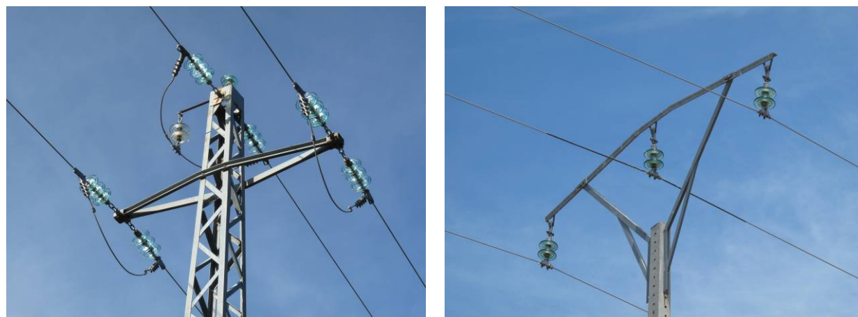
Figuras 1.8 y 1.9: Apoyo de amarre y apoyo de alineación con aisladores suspendidos
