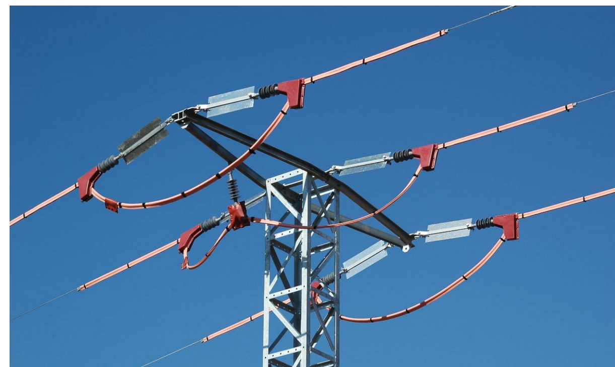
Figura 4.4. Aspecto de tendido en amarre con cruceta recta
