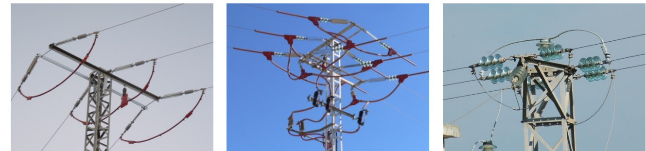
Figuras A6.1. a A6.3: Corrección de tendidos tipo LIFE, tipo FEDER y tipo aislamiento
