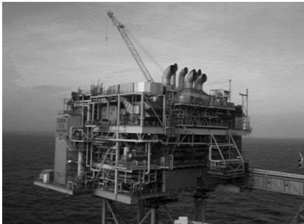
Figura 7.21: Ejemplo de una central eléctrica de ciclo combinado instalada sobre una plataforma marina de la plataforma continental Noruega [25, ABB, 2000]
