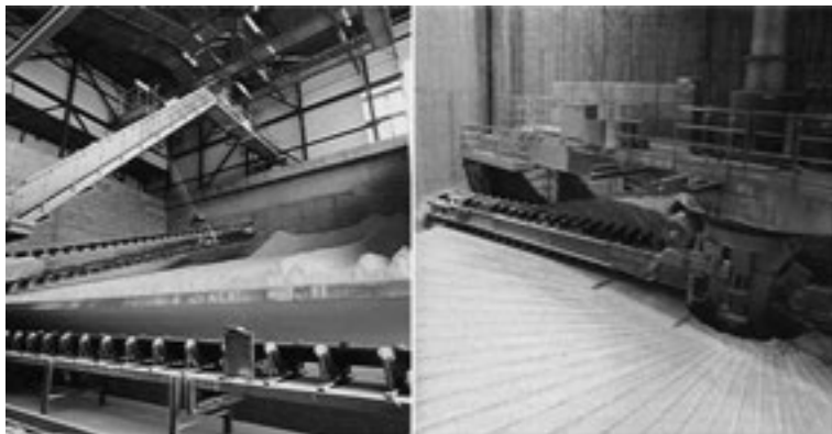
Figura 4.23: Almacén cerrado de yeso [94, Umwelt + Technik, 2000]
