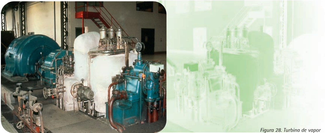
Figura 28. Turbina de vapor
