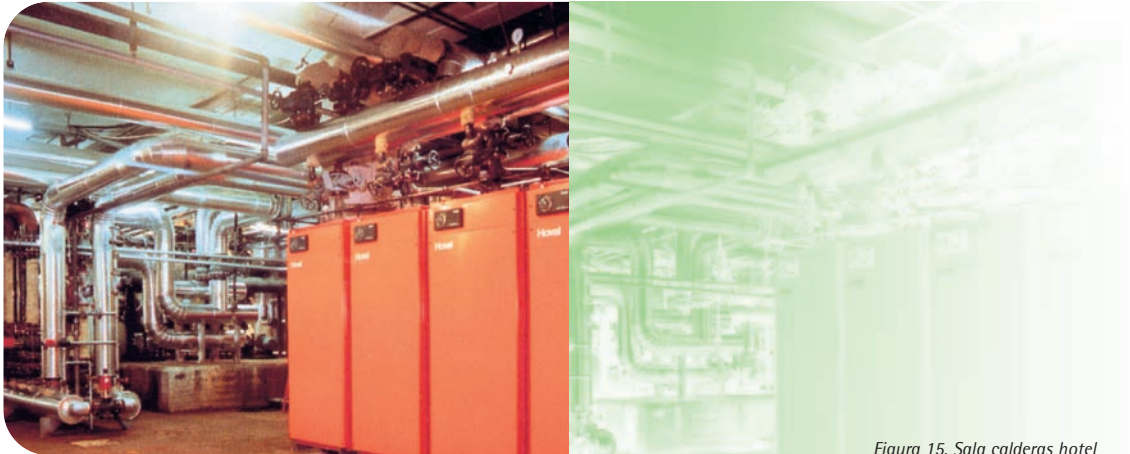
Figura 15. Sala calderas hotel
