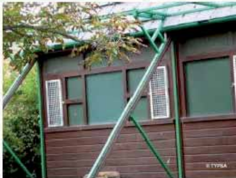
Ilustración 31. Detalle de pérdidas de calor a través del acabado de uralita (zona verde) de las fachadas de las Residencias.
