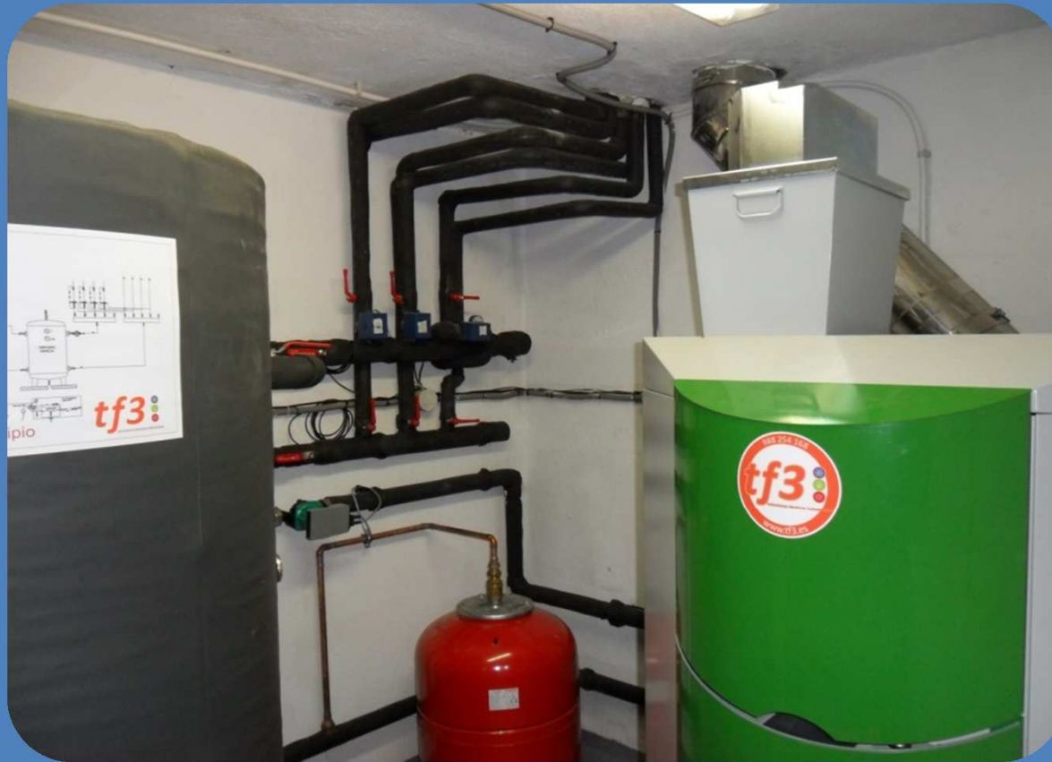
Sala de calderas
