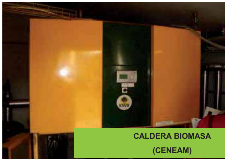
CASA PARA CALDERA Y ALMACÉN ASTILLA PARA CALDERA BIOMASA PARA RESIDENCIA (CENEAM)
