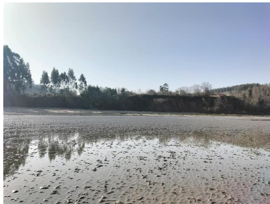
Fotografía nº17: Zona de inestabilidad del talud, vista desde la playa do Regueiro
