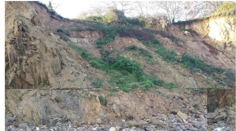
Fotografía nº3: Desprendimientos en taludes de la zona oeste de la playa do Regueiro
