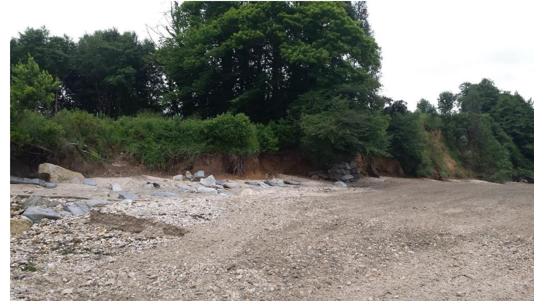
Erosión de la costa.
