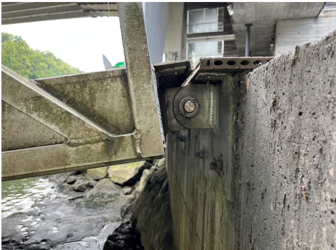
Figura 5. Detalle del apoyo de la pasarela en la viga cargadero de la margen izquierda
