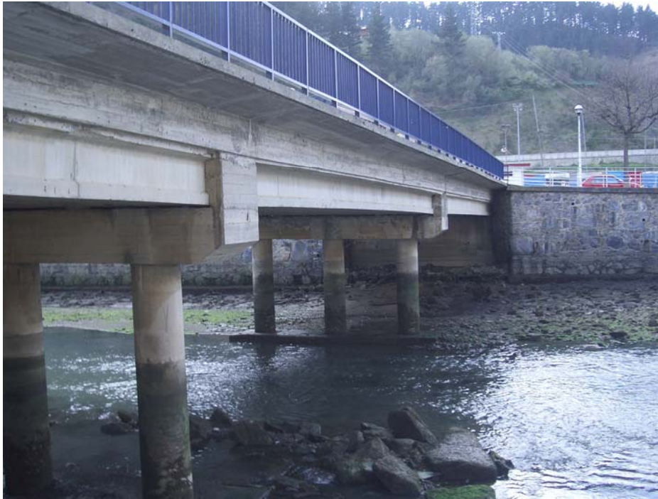
Fotografía nº 3. Vista lateral inferior desde la margen izquierda. Se aprecia las pilas y el estribo de la margen derecha.
