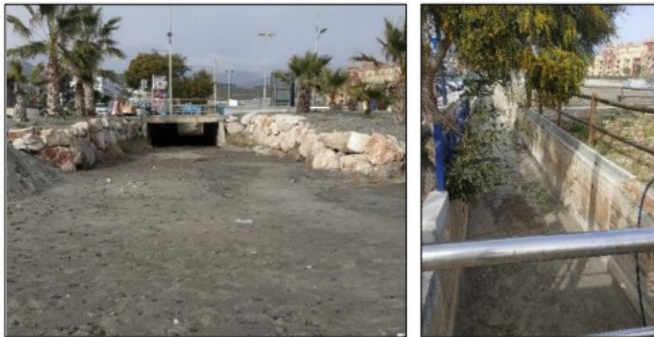
Ilustración 5. Desembocadura en la playa de Ferrara del arroyo El Mascuñar (Fuente: Estudios preliminares y elaboración de alternativas).
