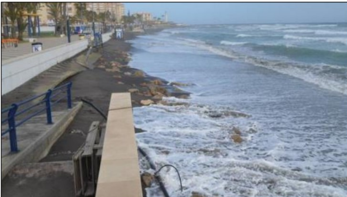
Ilustración 74. Temporal en la playa de Ferrara alcanzando el mobiliario existente.
