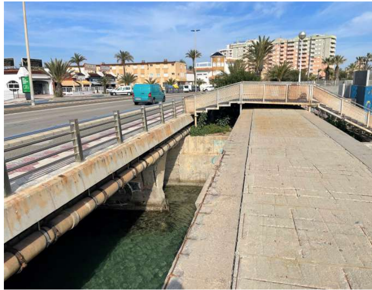
Figura 17. Ferralla al descubierto.
