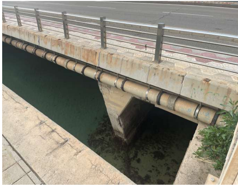
Figura 5. Ferralla al descubierto de las instalaciones margen derecha.
