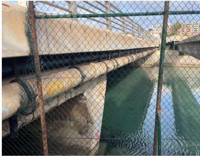
Figura 9. Vallado deteriorado desde margen izquierda.
