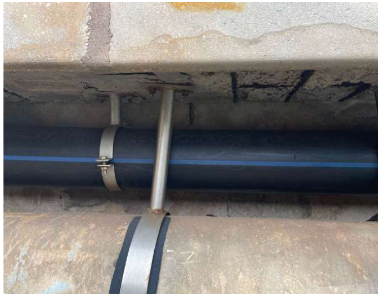
Figura 12. Descorchamientos de hormigón.
