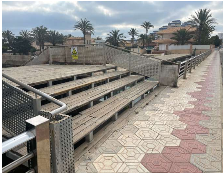
Figura 6. Estado escaleras de acceso y barandillas desde Gran Vía de La Manga.
