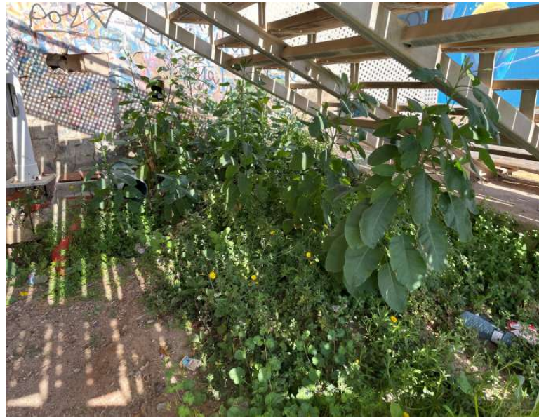
Figura 21. Vegetación y basura bajo escaleras de acceso margen derecha.
