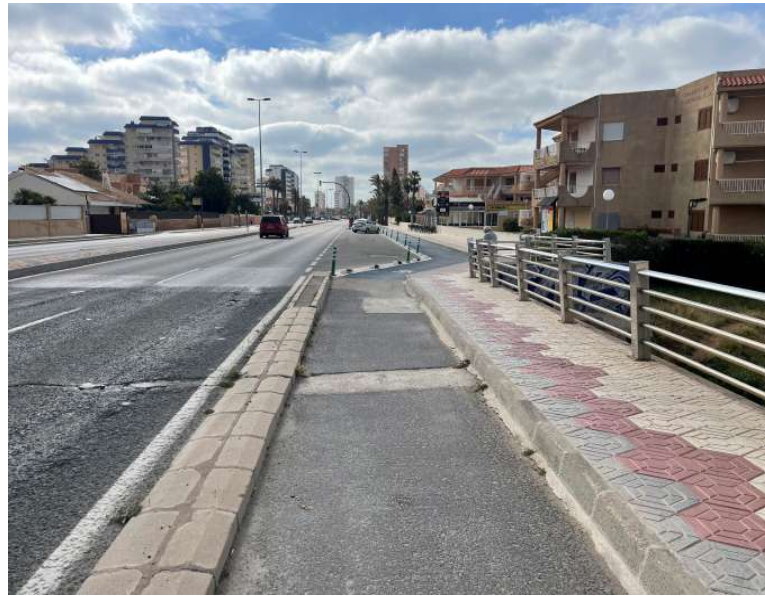
Figura 15. Mal estado de carril bici.
