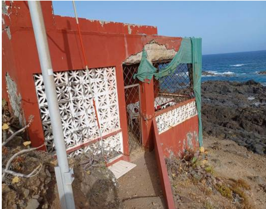
Se observa el cierre de la terraza mediante celosía de hormigón y reja.
