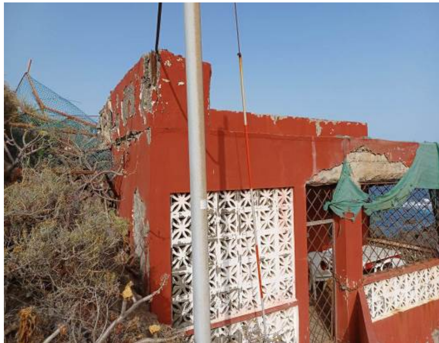
Se observa la parte superior de la vivienda y el cierre metálico que se encuentra caído.
