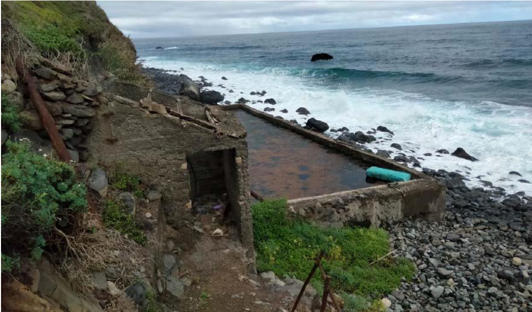
Vista de la charca por la parte Este, cuarto de la bomba derruido múltiples veces por los turistas que frecuentan el Camino Real de la zona de Los Realejos.
