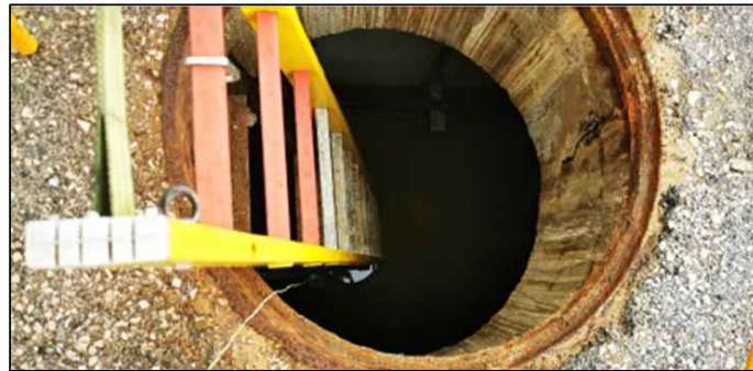
Figura 17.- Cámara de playa del cable fuera de servicio Rioja-1. Fuente: NEC.
