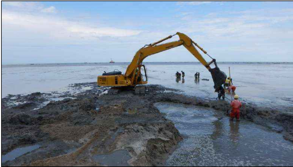
Figura 8.- Enterramiento del cable en la playa por medio de una excavadora. Fuente: NEC.
