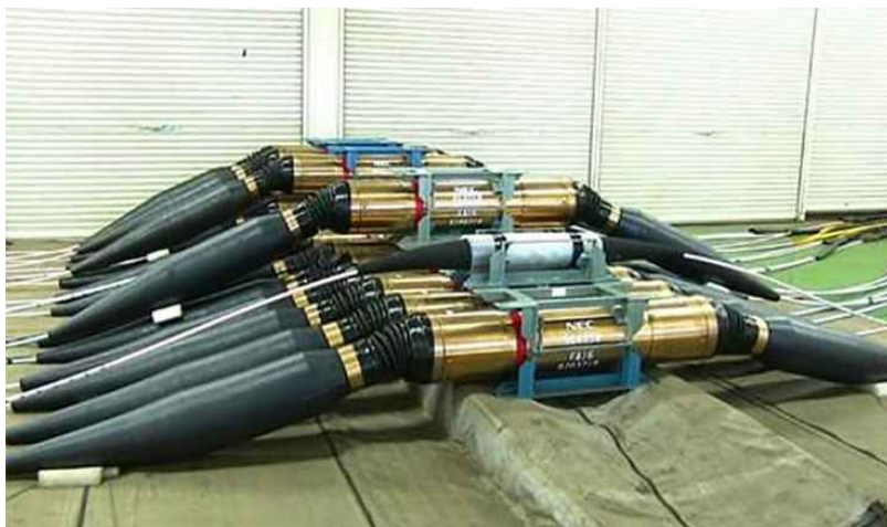
Figura 34. Ejemplo de una pila de repetidores. Fuente: NEC.
