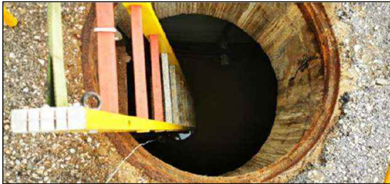
Figura 17.- Cámara de playa del cable fuera de servicio Rioja-1. Fuente: NEC.
