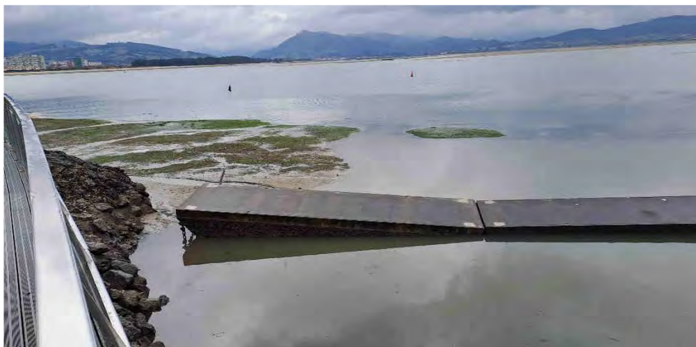
Figura 2. Detalle del grado de inclinación del rompeolas de hormigón varado en el fondo
