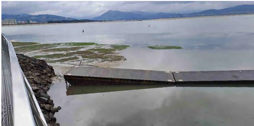
Figura 2. Detalle del grado de inclinación del rompeolas de hormigón varado en el fondo. Extremo este
