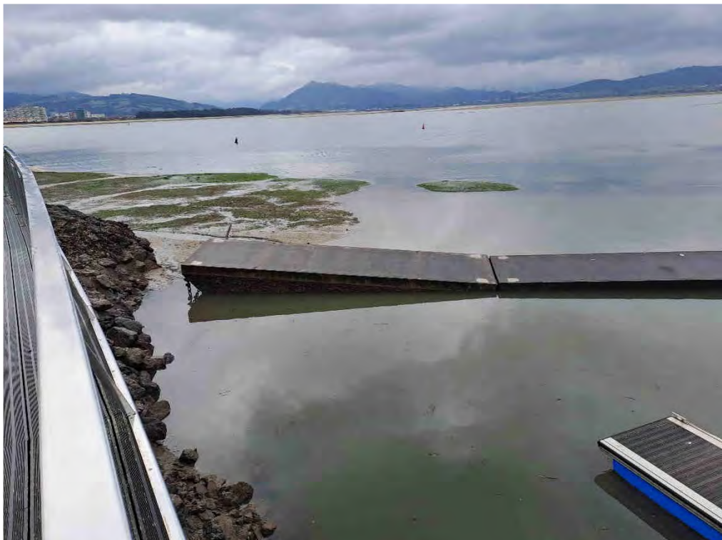
Figura 3. Detalles donde se aprecia el grado de inclinación del rompeolas de hormigón varado
