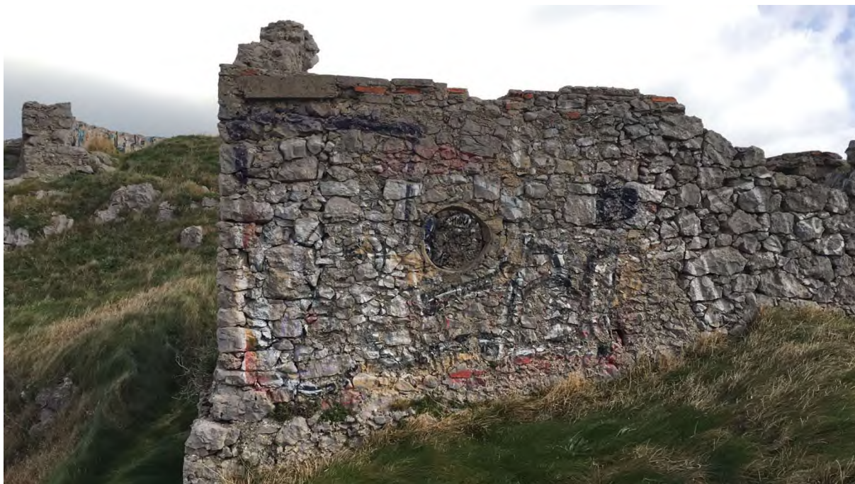
Ilustración 13: Vista en detalle del fortín, en la zona suroeste (zona con riesgo de caídas)
