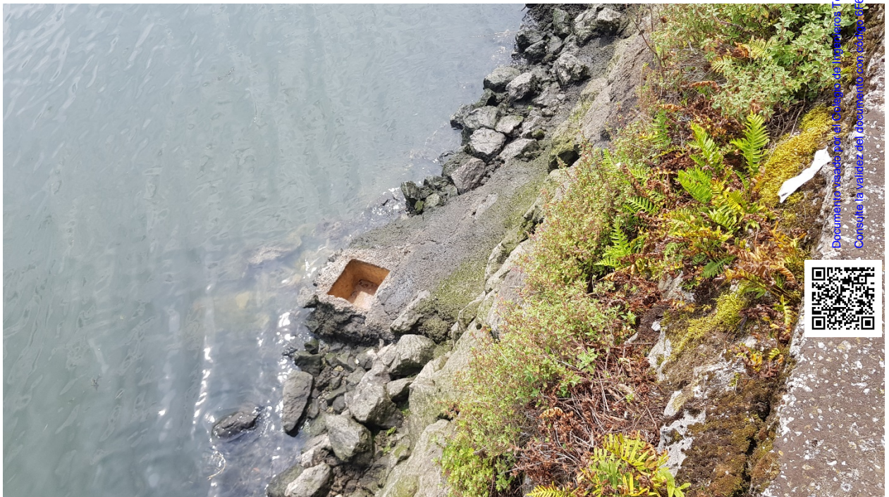
Foto N° 10.- Arqueta de vertido a la Ría de Treto, sin tapa para favorecer su dispersión. En margen izquierda de la Ría.
