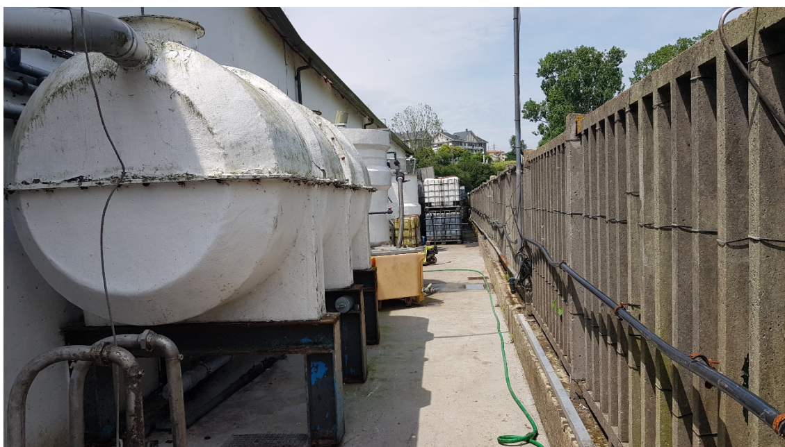
Foto N° 1.- Balsa separadora de grasas, aceites e hidrocarburos \phi 1'5 m x 4'80 m.
