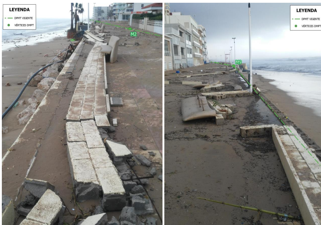
Figura 4. Daños producidos por el temporal "Gloria" en el paseo marítimo de Bellreguard.
