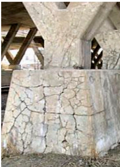
Figura 8. Grietas por reacción de agregado álcali
