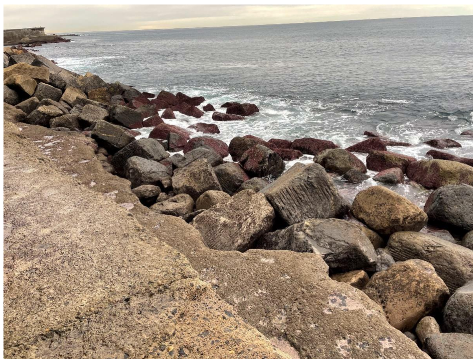
Ubicación de zona con falta de bloques
