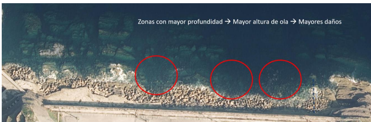
Zonas donde se producen los mayores daños debido a un calado mayor (implica mayor altura de ola).
