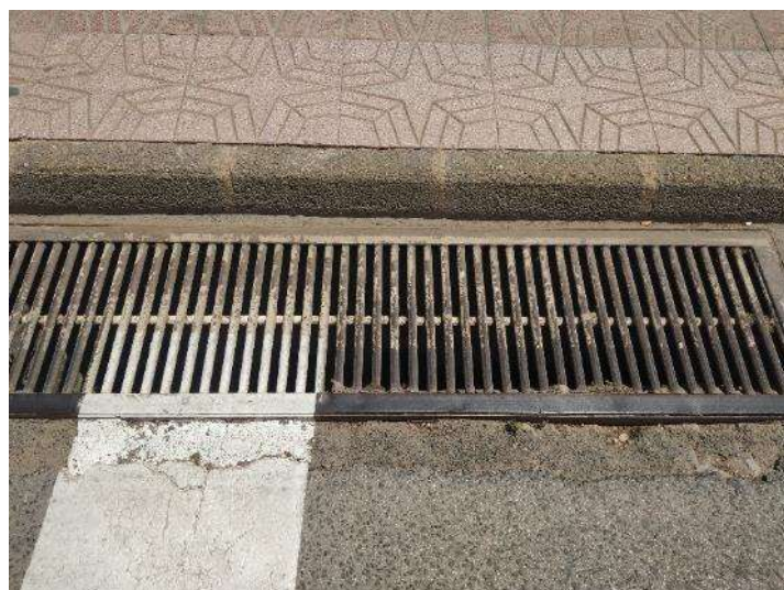
Detalle del imbornal situado en el borde exterior de la carretera en el Paseo los Castillitos.
