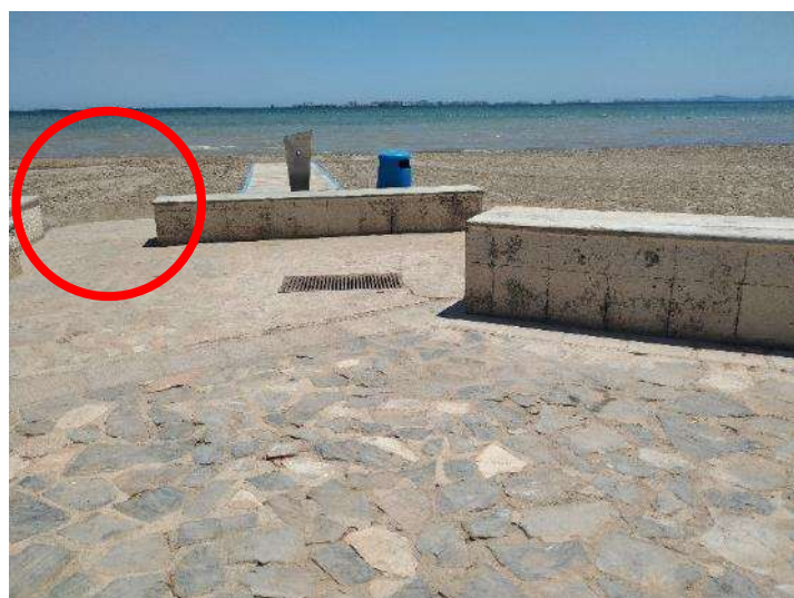
Vista general del imbornal situado en el acceso a la playa del Paseo los Castillitos y del punto de vertido (señalada ubicación aproximada).
