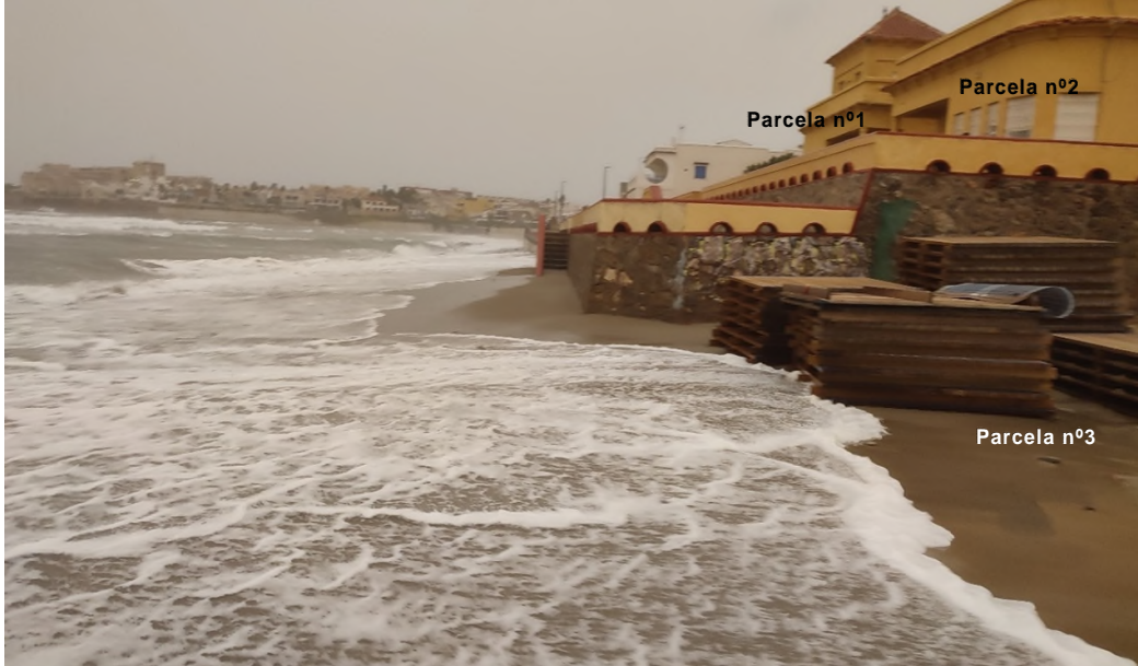
Figura.31. Vista de la parcela nº1 y nº2 del proyecto de deslinde concesión C-229-MU en primera línea de mar, donde se observa que el oleaje sobrepasa la vivienda por su fachada oeste.
