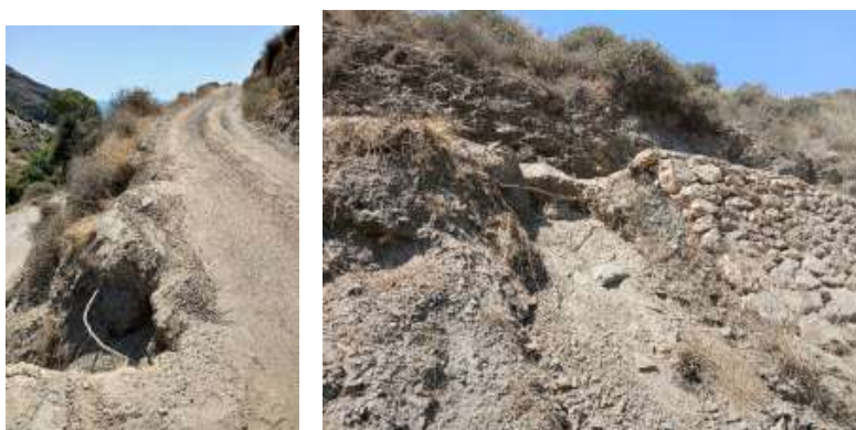
Imágenes 15 y 16. Detalle del socavón y descalce de la mampostería en seco en el borde del camino, provocado por escorrentía superficial.
