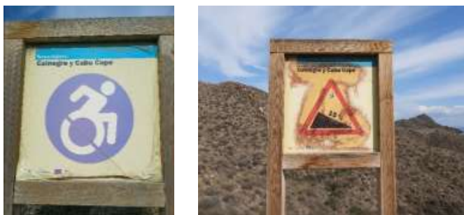
Imagen 21 y 22. Estado de dos de los vinilos a substituir.
