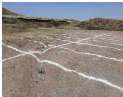
Imagen 10. Procesos de erosión superficial (zanjas y cárcavas) en el aparcamiento disuasorio del sector Calnegre.
