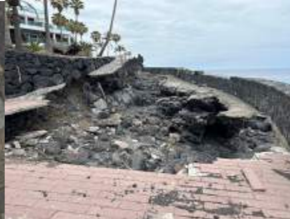
Zona socavada por el oleaje al final del paseo
