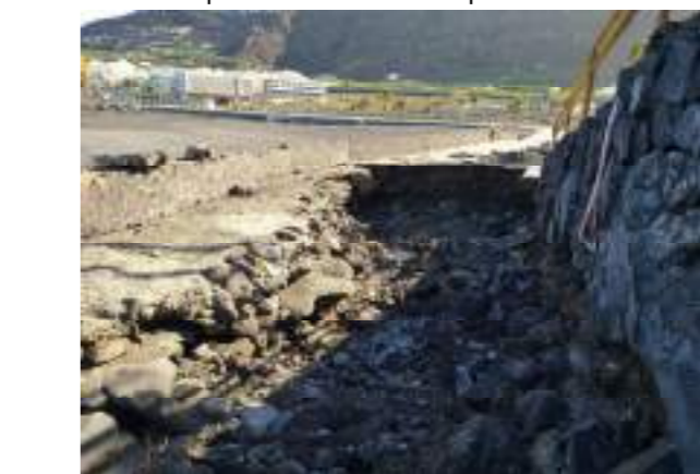
Vista del socavón del paseo
