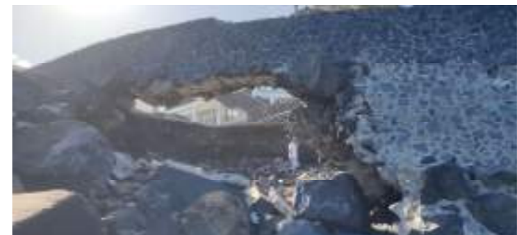
Parte del muro dañado y situado en DPMT
