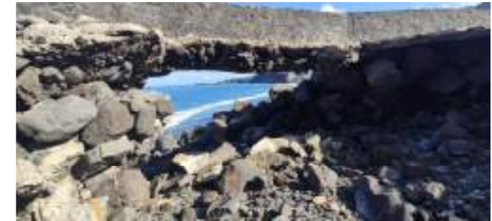
Daños en paseo marítimo en esquina sur del mismo
