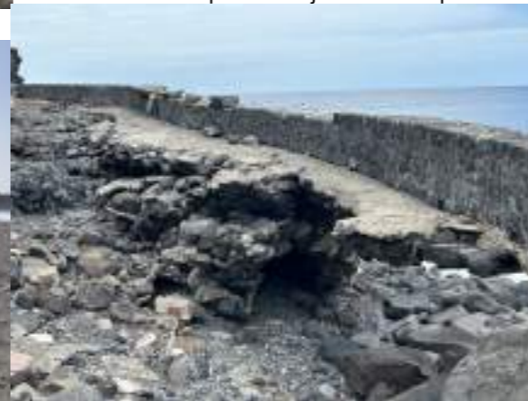
Situación de socavón en final de paseo y playa
