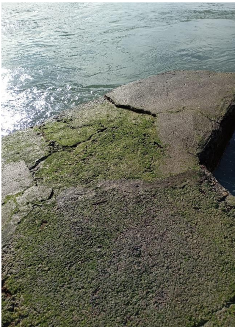
Embarcadero. Estado actual y patologías
