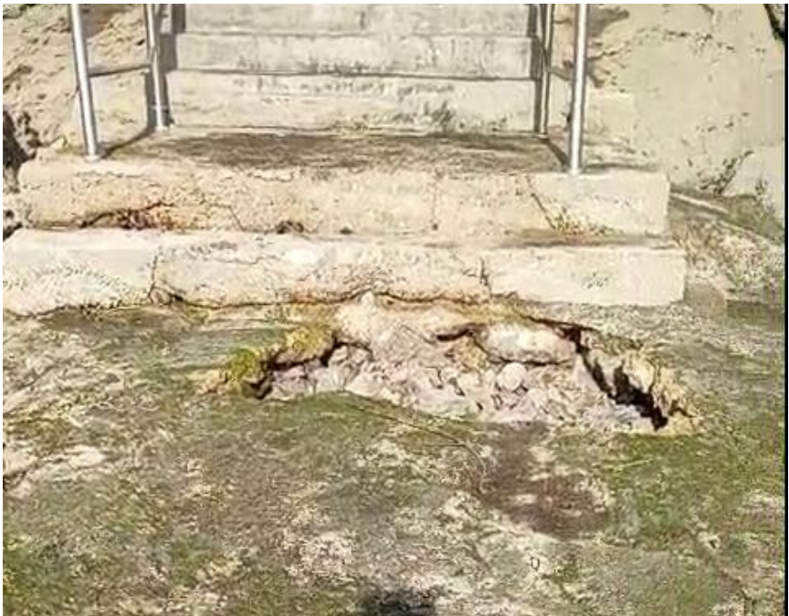
Embarcadero. Estado actual y patologías
