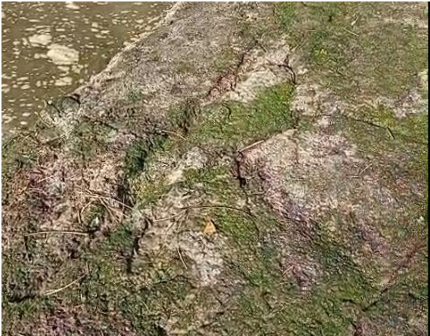
Embarcadero. Estado actual y patologías
