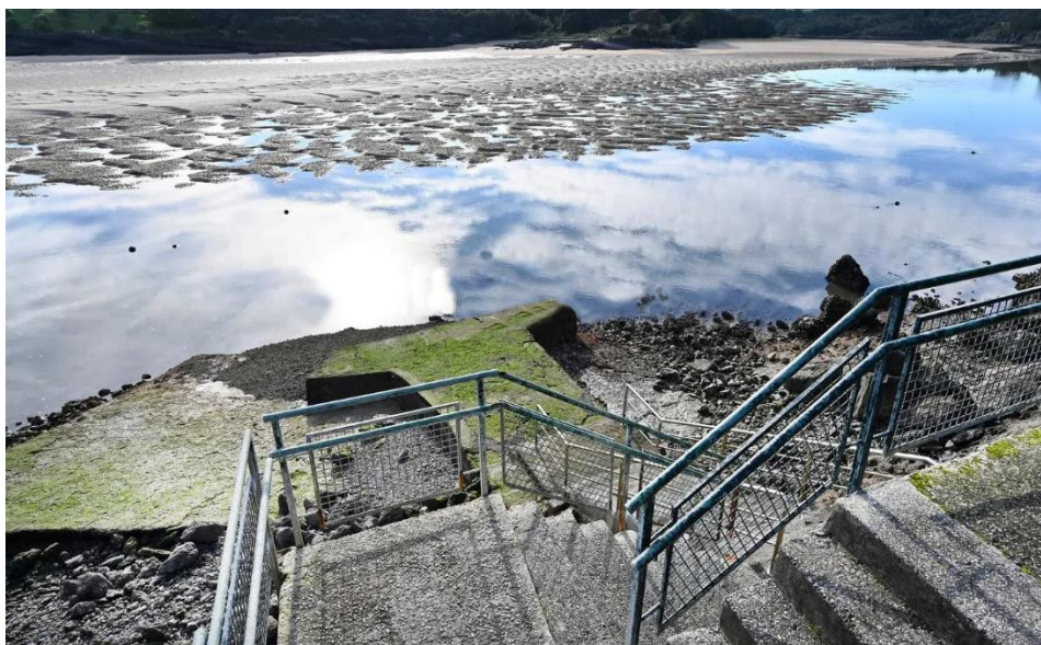
Escaleras y embarcadero. Estado actual.
