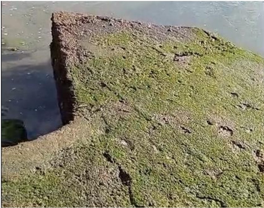
Embarcadero. Estado actual y patologías
