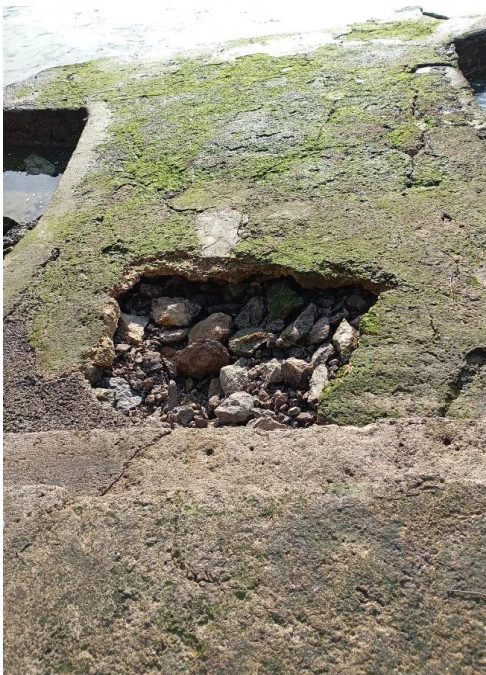
Embarcadero. Estado actual y patologías
