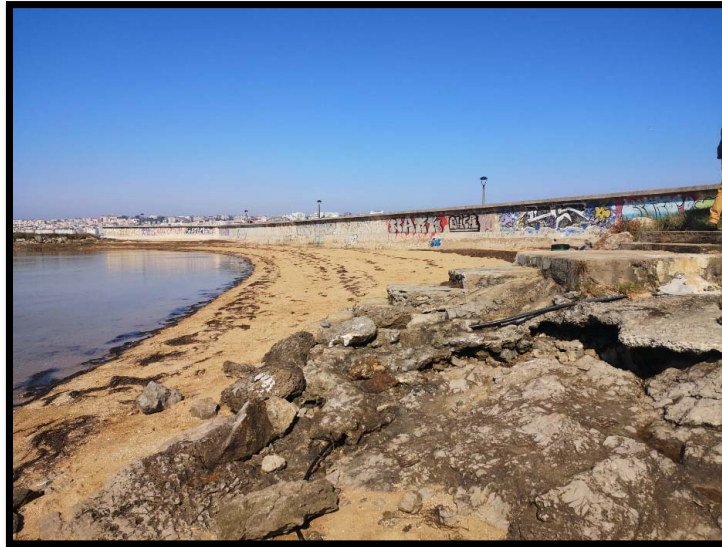
Figura 3. Detalle de Contención Inestable.
