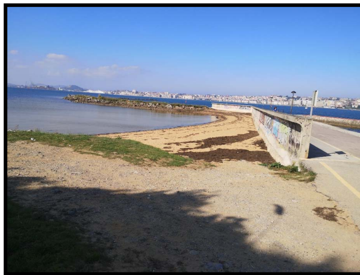
Figura 2. Detalle de Plataforma irregular y Muro Rompeolas.
