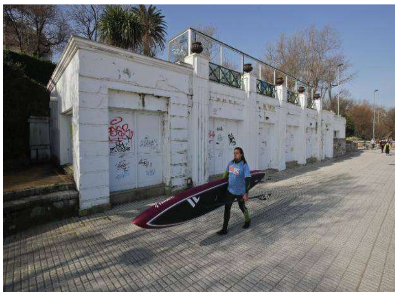
Imagen del estado de conservación actual, que justifica la necesidad de la actuación de rehabilitación.
