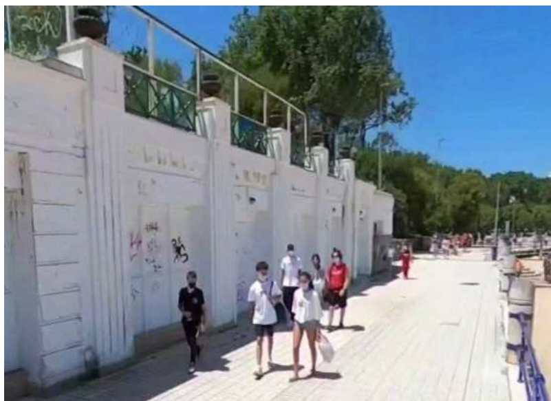
Estado actual del edificio desde el paseo marítimo, apreciándose el deterioro de los elementos constructivos.
