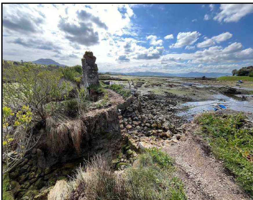
Imagen 2.- Estado actual muro visto desde la senda peatonal
