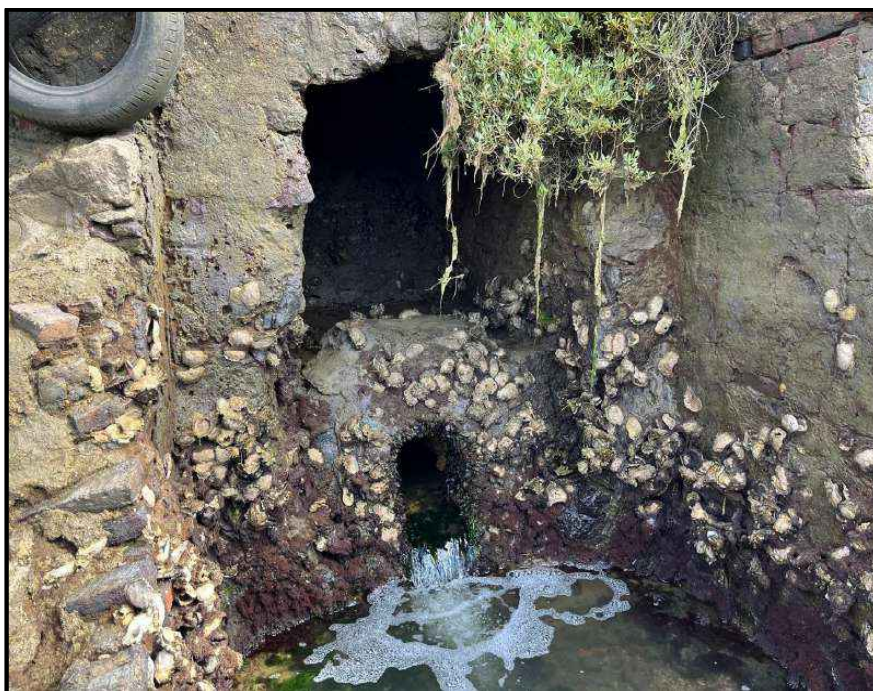
Imagen 3.- Conducto de comunicación a través del muro
