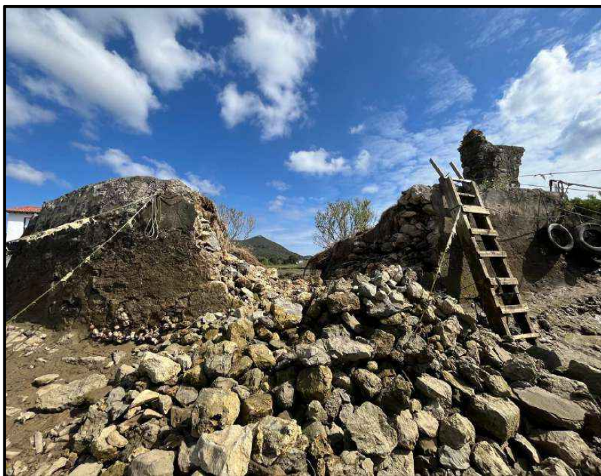
Imagen 1.- Estado actual muro derruido
