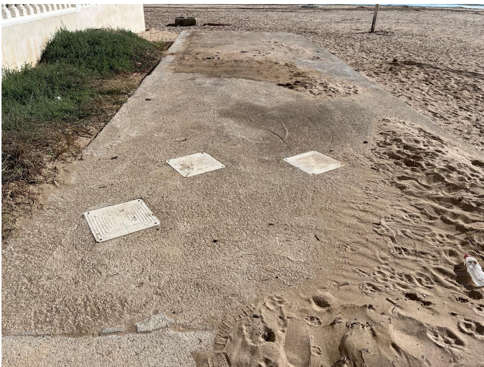
Ilustración 2. Arquetas actuales ubicadas al lado de los nuevos módulos.
