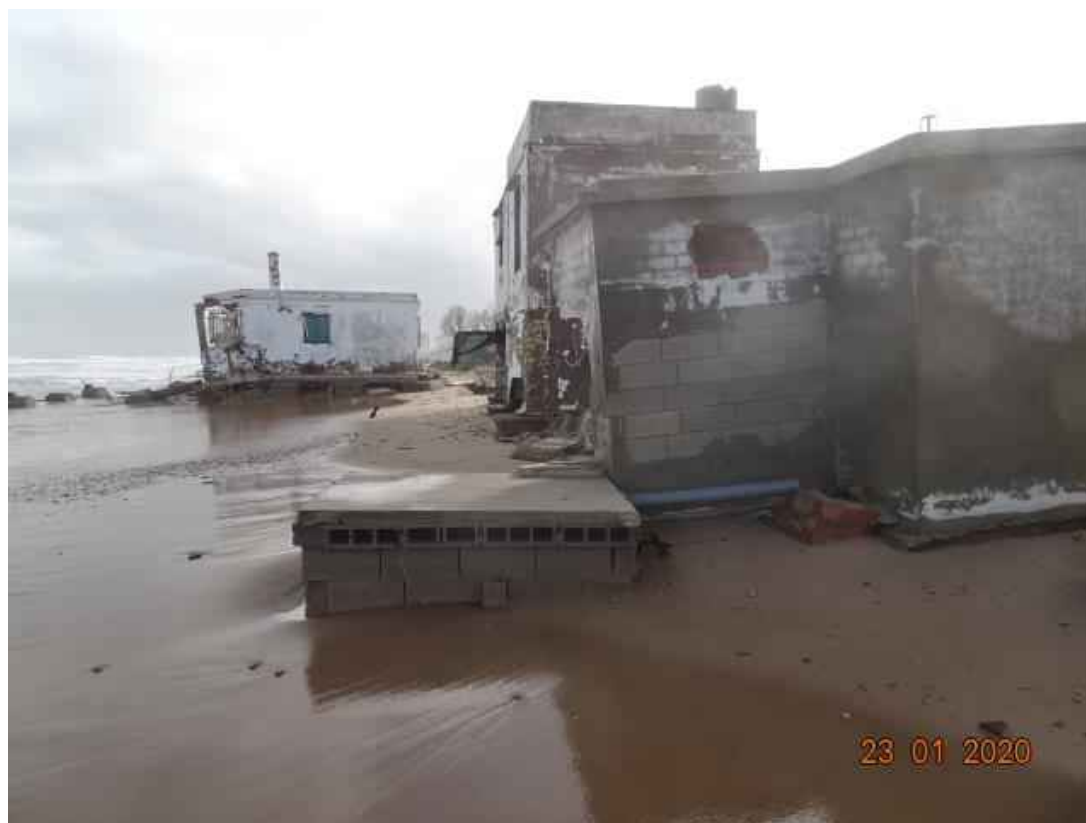
Fotografía 12. Afección del temporal “Gloria”, vértices M-446 y M-447.
