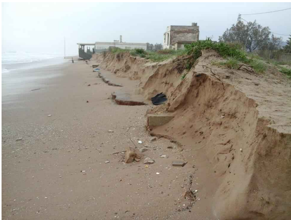
Fotografía 4. Afección del temporal de 2019, vértices M-442 y M-445.
