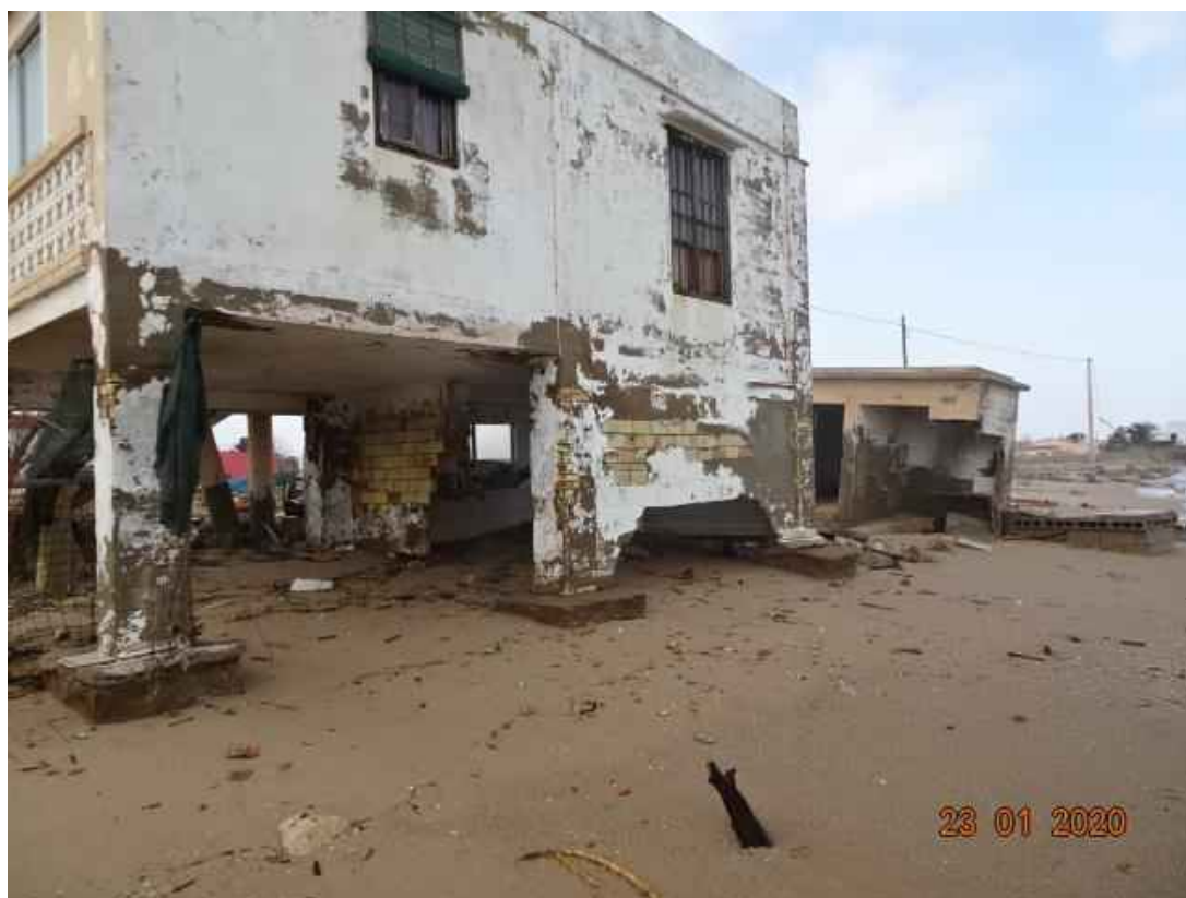
Fotografía 13. Afección del temporal “Gloria”, vértices M-446 y M-447.
