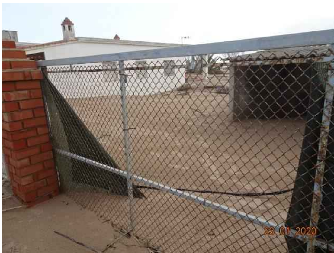
Fotografía 20. Afección del temporal "Gloria", vértices M-446 y M-447.
