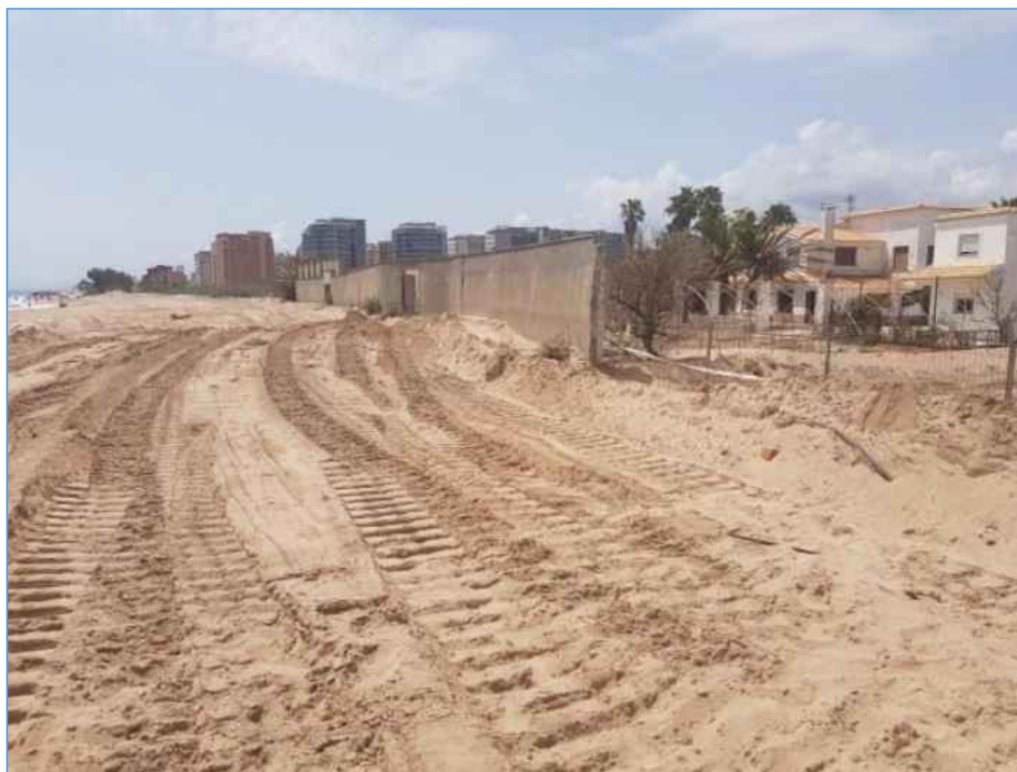
Figura 33. Detalle del derribo parcial del muro perimetral de una parcela ubicada en la zona sur de estudio tras el temporal de 2020.
