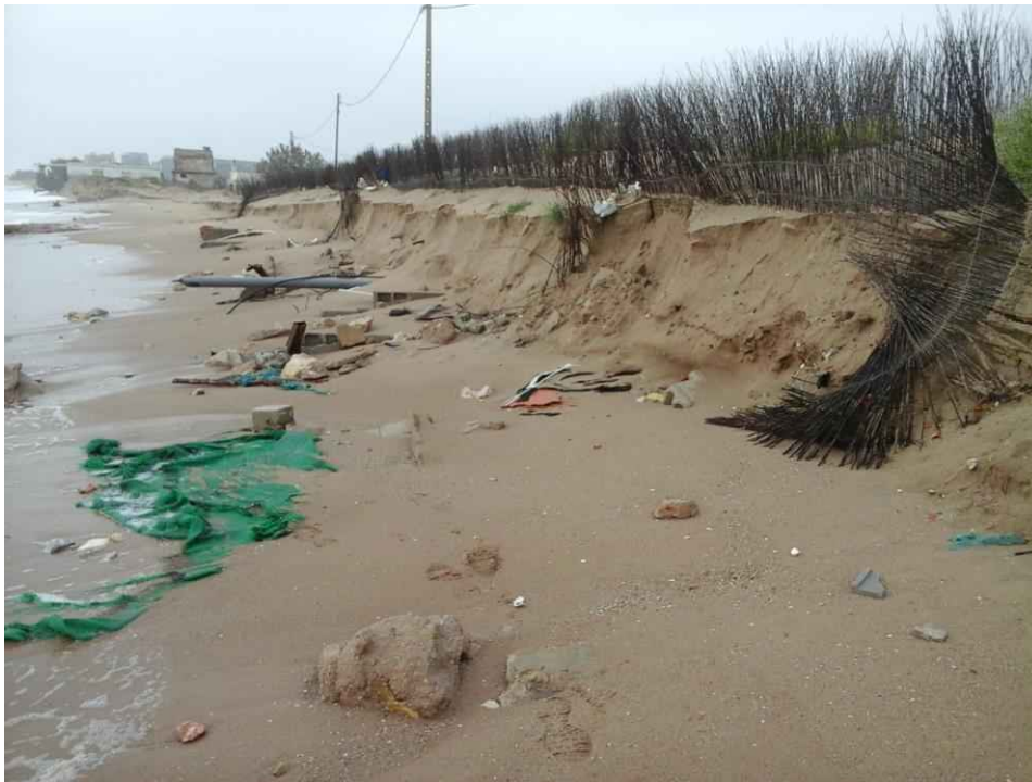
Fotografía 3. Afección del temporal de 2019, vértices M-444 y M-445.
