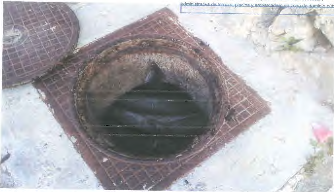
F-37: Vista en dirección noroeste de la arqueta de paso que conecta el desagüe de la piscina con la red de saneamiento, a la salida de la zona ajardinada.
