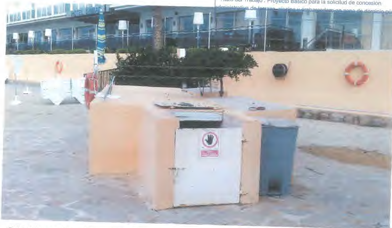
F-25: Vista en dirección noroeste del cuarto que alberga las instalaciones de depuración de agua de la piscina.
