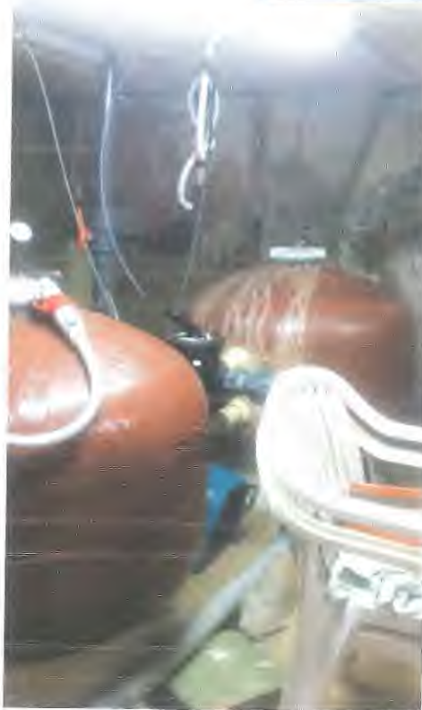
F-35: Vista en dirección noroeste del interior del cuarto de instalaciones de la piscina.
