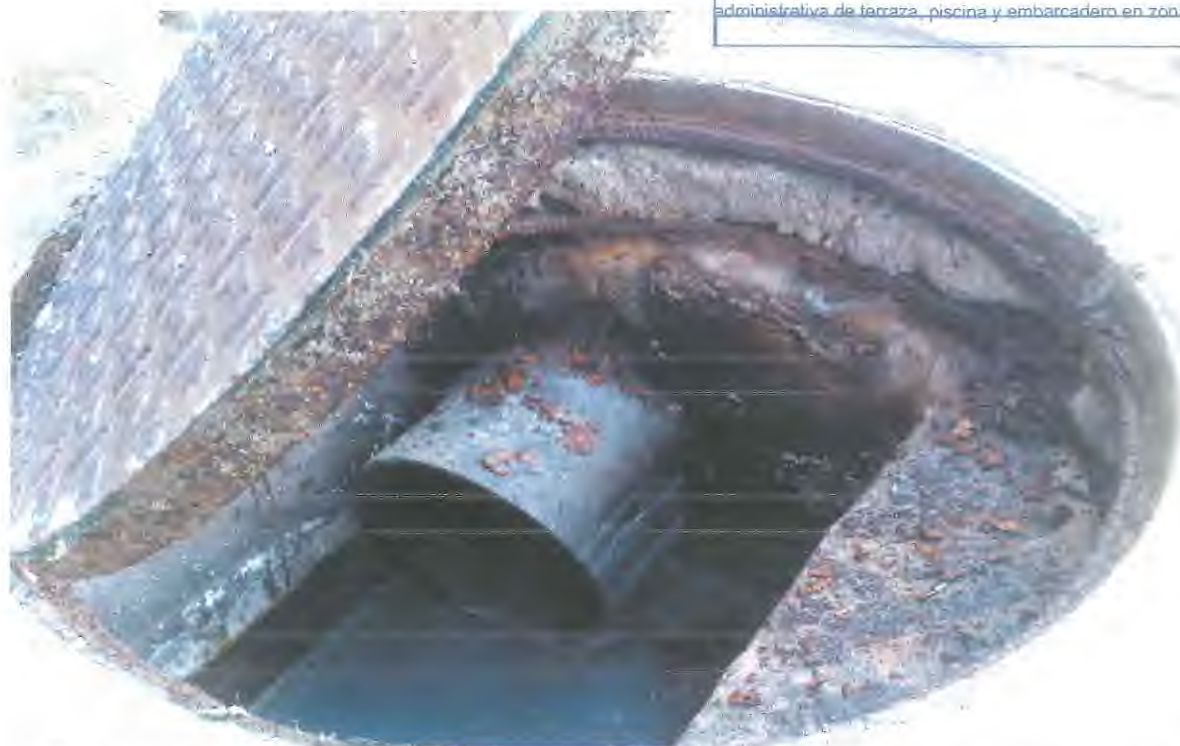
F-38: Vista en dirección noreste de la arqueta de recogida previo a la red, que conecta el desagüe de la piscina con la red de saneamiento.
