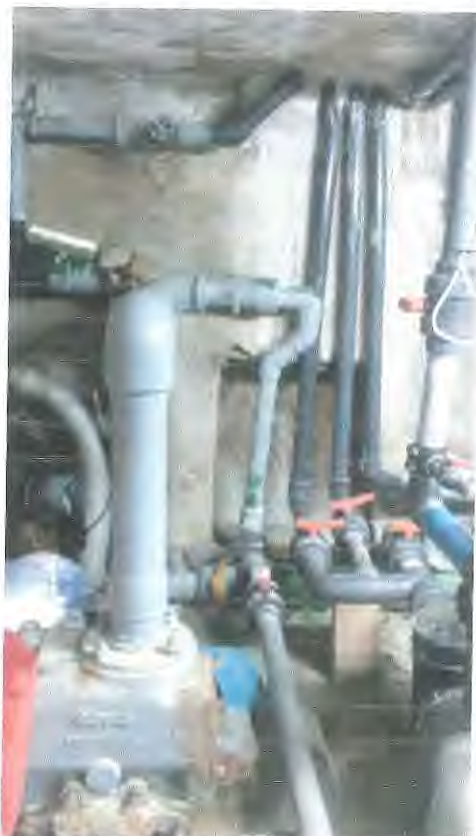
F-36: Vista en dirección noroeste del interior del cuarto de instalaciones de la piscina.
