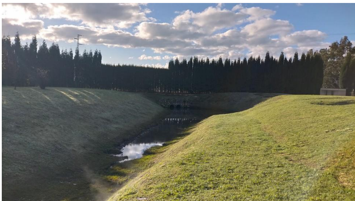
Figura 21. Arqueta de comunicación de agua salina entre parcelas 1 y 2
