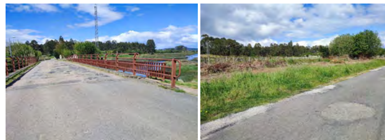
Pavimento de la calzada del puente dañado Zona con reparaciones
