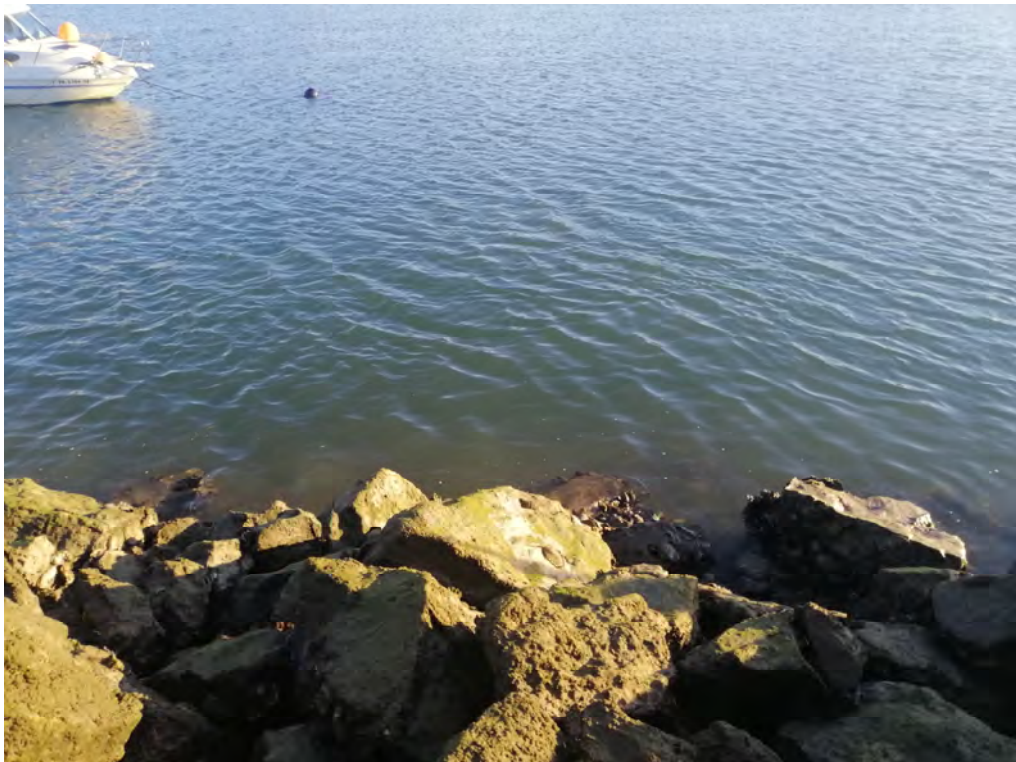
Tramo Pk 30: derrames de escollera en el pie del talud.
