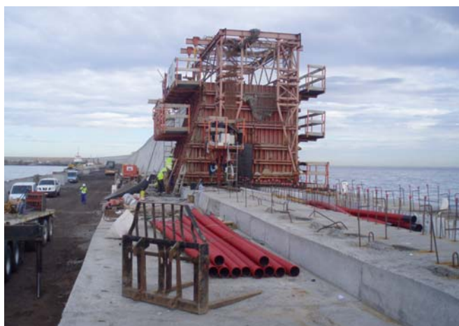
Figura 31. Dique de la Esfinge (2ª fase) en el Puerto de Las Palmas (Fuente: Anuario Estadístico de Puertos del Estado 2010)
