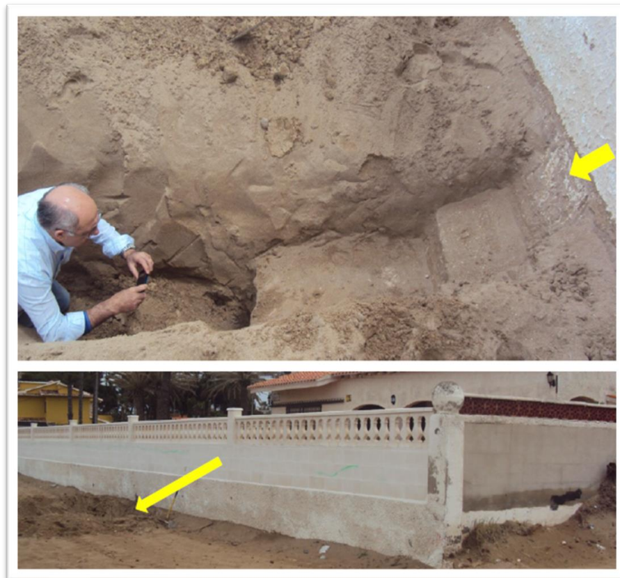
Fotografía aportada por los alegantes y que se corresponde con una calicata efectuada por ellos mismos para descubrir el terreno en el que se sitúa el cimiento de su muro.
