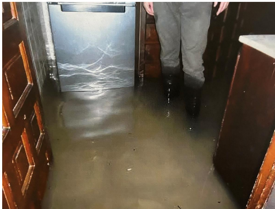
Fotografía aportada por este alegante el día 30/08/2017 en la que se aprecia el interior de su vivienda completamente anegado por el agua del mar tras el temporal acaecido en enero de 2017.
