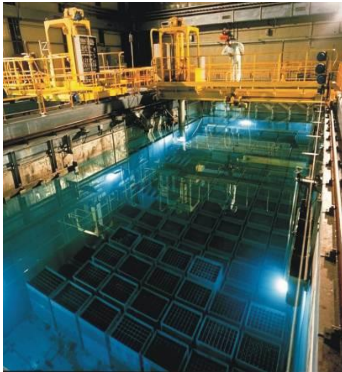
Figura 13. Piscina de almacenamiento de CG
