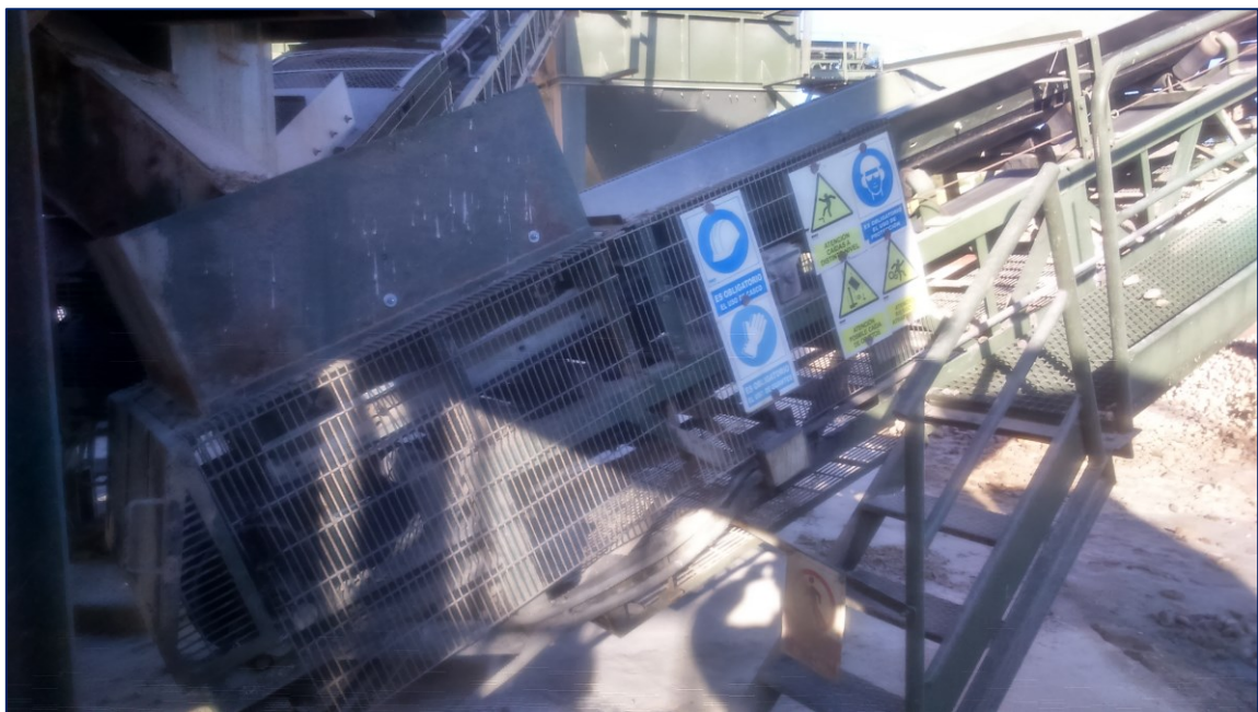
Ilustración 7-9 Vistas Protecciones Tambor Cola
