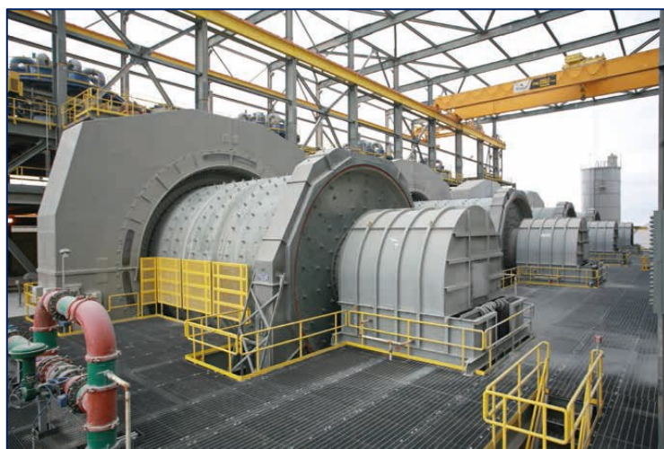
Ilustración 6-64 Resguardo de distancia para Molino (motor anular); dispositivo disuasivo (barandillas) contra deslizamiento y caída. Fuente: ThyssenKrupp
