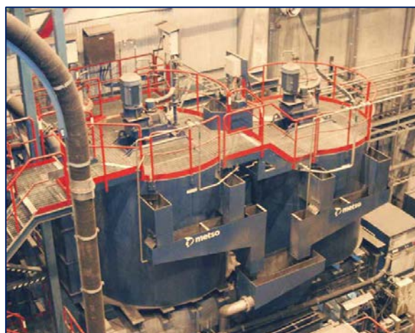
Ilustración 6-105 Medios De Acceso (Plataformas, Barandillas, ...) En Celda De Flotación. Fuente Metso
