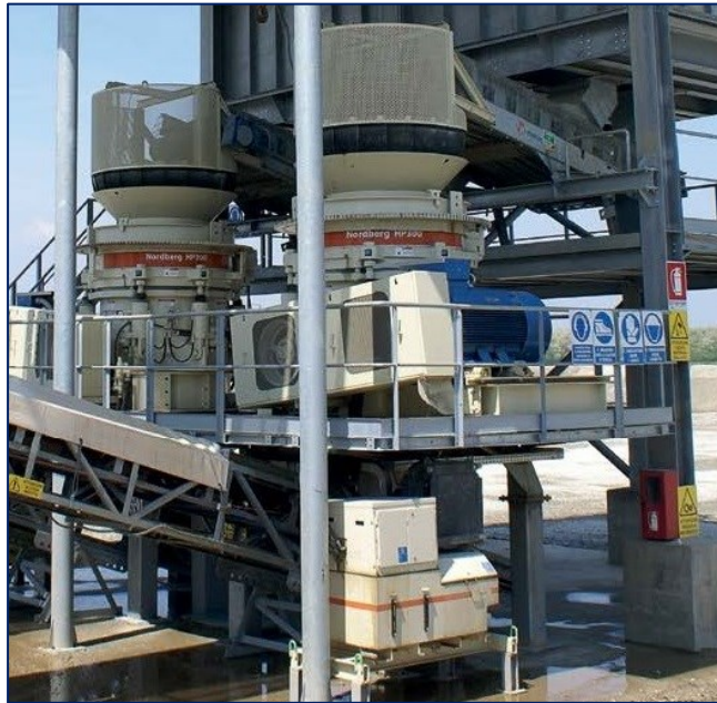
Ilustración 6-54 Resguardos De Elementos De Transmisión En Conos, Junto Con Dispositivo De Malla Para Evitar Proyecciones De Material. Fuente: Metso
