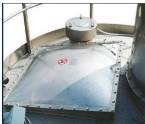
Ilustración 6-80 Válvula De Seguridad Y Panel Antiexplosión En Parte Sup. Silo
