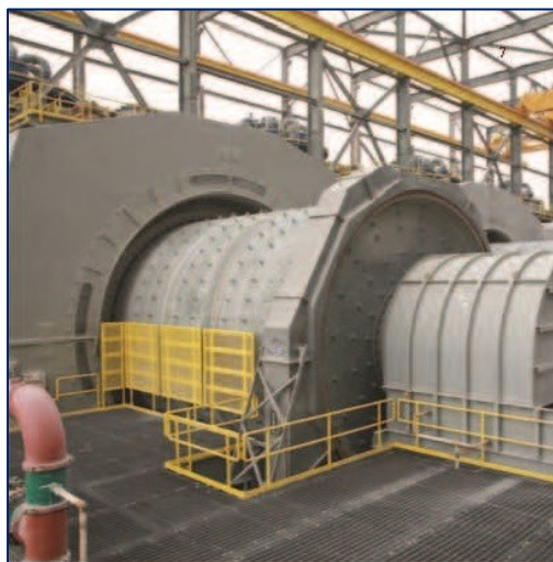
Ilustración 6-59 Equipo De Molienda Con Accionamiento Por Motor Anular. Fuente: Thyssenkrupp
