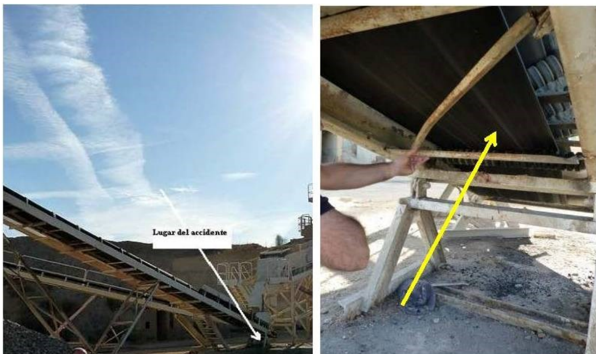
Ilustración 7-4 Vistas Lugar Accidente Por Atrapamiento De Rodillo Inferior
