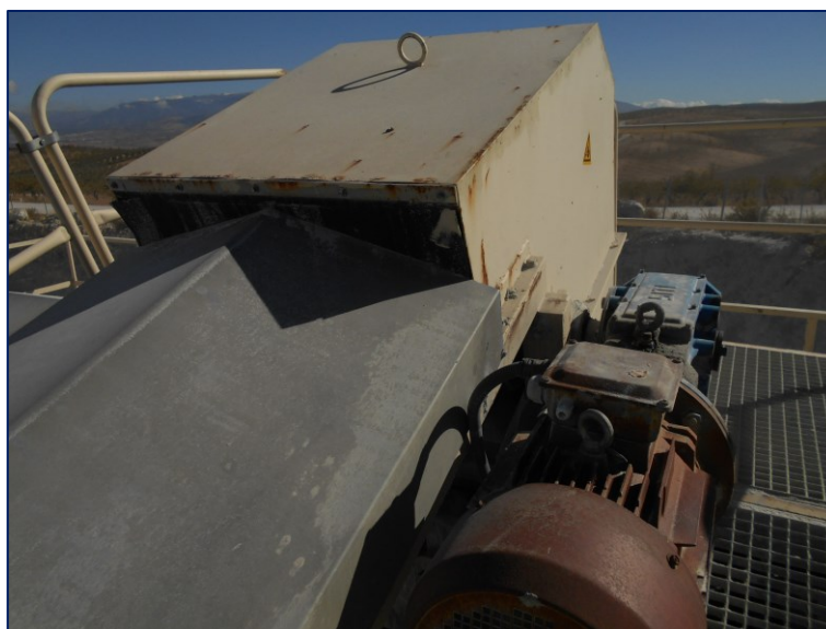
Ilustración 6-21 Resguardos Cabeza Motriz (Motorreductor) Cinta Transportadora
