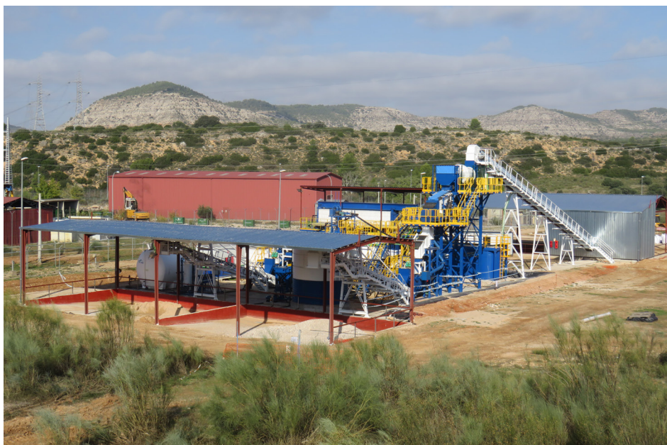
Imagen de la planta para el tratamiento de suelos en la central nuclear de José Cabrera.
